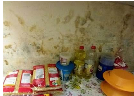
Infiltrações e pintura danificada
