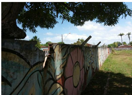
Cerca e muro danificados
