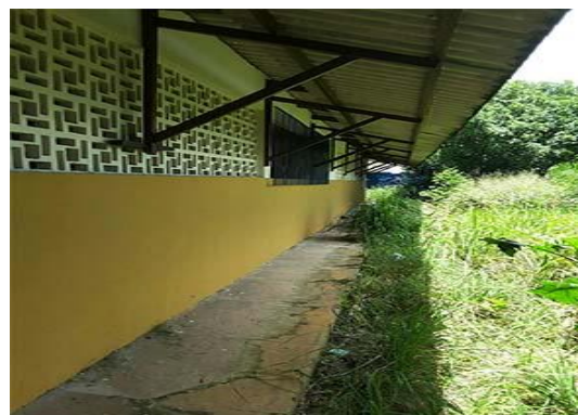
Necessidade de capinação da área externa
