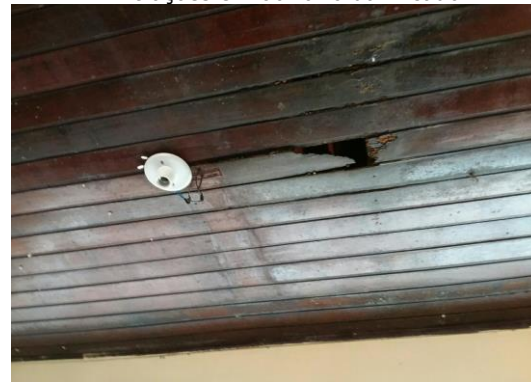
Forro danificado e lâmpada inexistente
