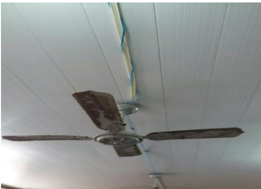
Ventilador danificado e fiação exposta
