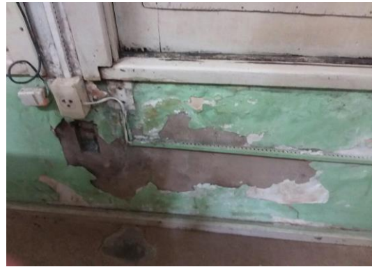
Infiltrações, pintura danificada e fiação exposta
