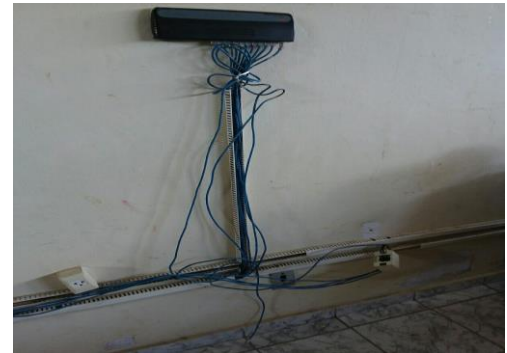
Fiações expostas e improvisadas
