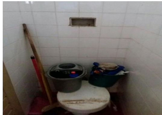
Vasos sanitários sem descarga
