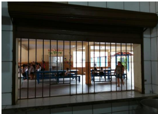
Tela de proteção nas aberturas externas inexistente
