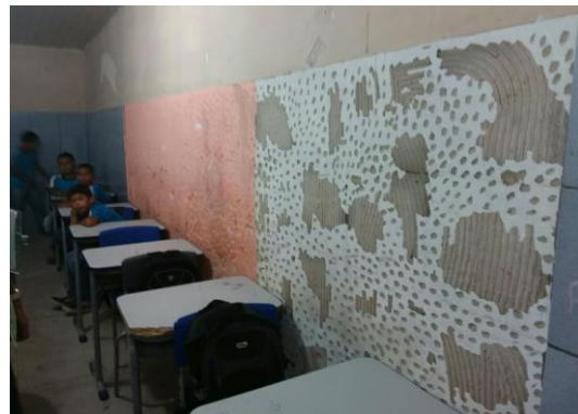
Revestimento e mobiliários danificados
