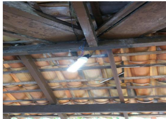
Fiações expostas e improvisadas
