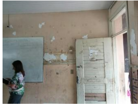
Pintura e porta danificadas
