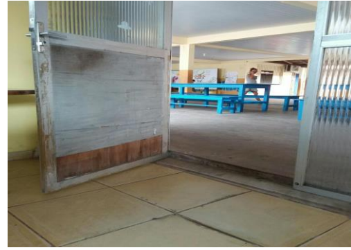
Portas danificadas e limitação de acesso a PcD
