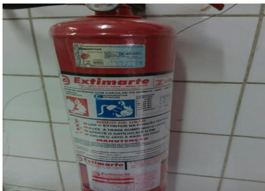
Extintores de incêndio com carga vencida
