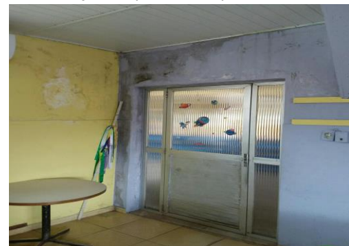
Pintura danificada e infiltrações
