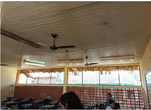
Ventilador e forro danificados, fiação exposta, lâmpadas queimadas e inexistentes
