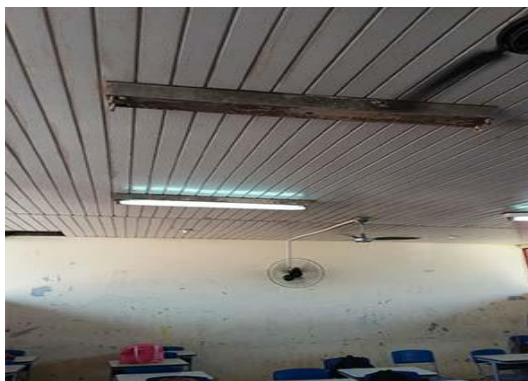
Lâmpadas inexistente, forro e ventilador danificados
