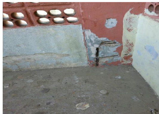
Queda de reboco com ferragem exposta
