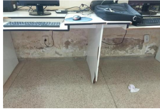
Infiltrações e mobiliário danificado
