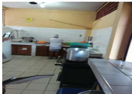
Inexistência de Exaustor
