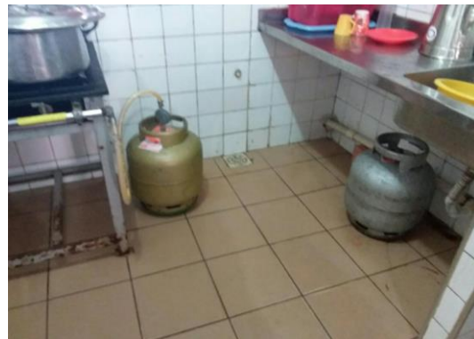
Botijão de gás em local inadequado
