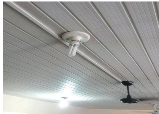
Iluminação insuficiente e lâmpadas queimadas
