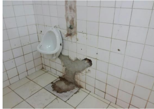
Vaso sanitário inexistente
