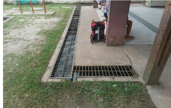
Sistema de drenagem inadequado
