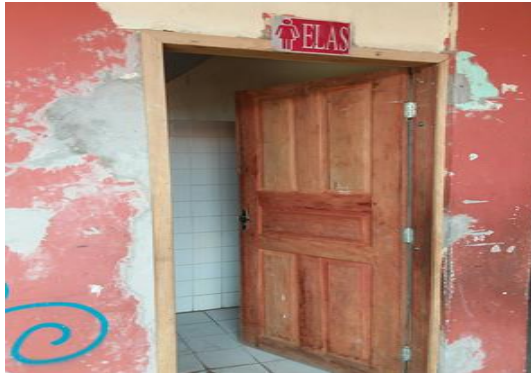
Pintura e revestimentos danificados
