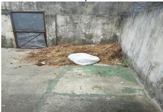
Inexistência de pintura e limpeza
