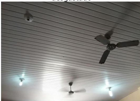
Lâmpadas inexistentes e ventilador danificado
