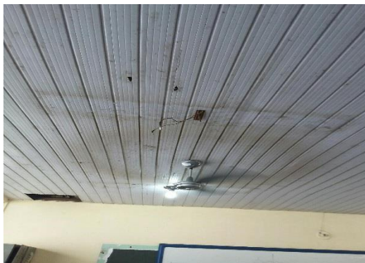
Lâmpadas ausentes, fiação exposta e forro danificado
