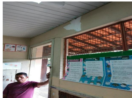
Queda de reboco
