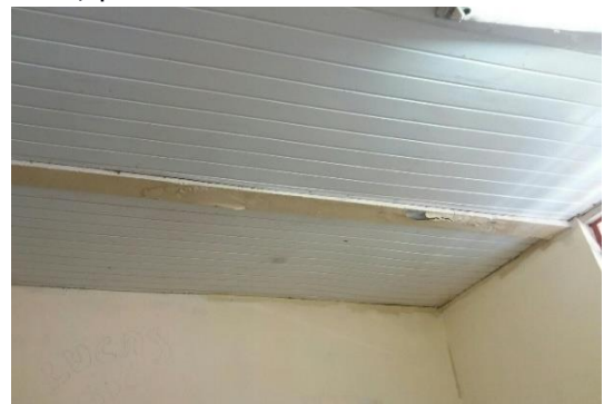
Infiltração e forro danificado
