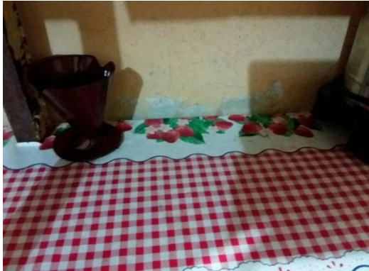
Revestimentos e pintura danificados
