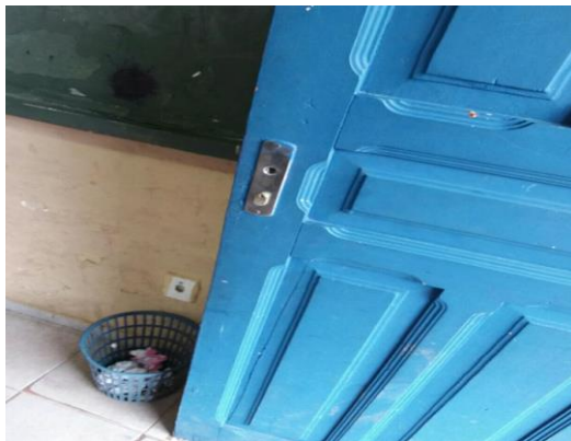
Porta sem fechadura
