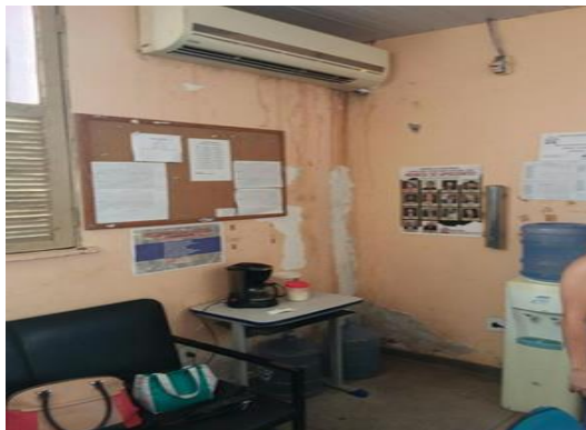
Ar condicionado danificado e infiltrações
