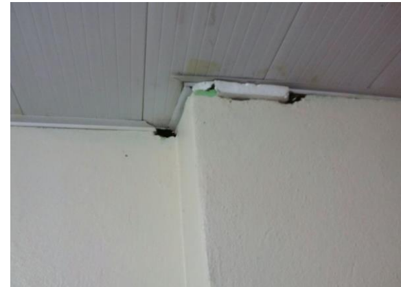
Impropriedades na estrutura
