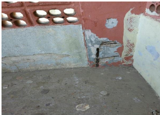
Infiltração, queda de reboco com ferragem exposta e piso danificado
