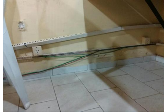
Fiações expostas e improvisadas
