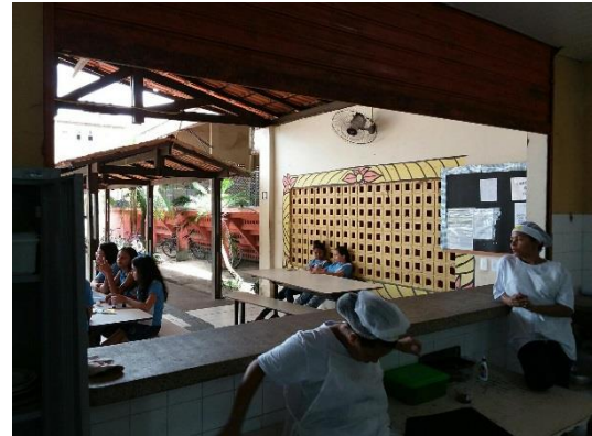
Inexistência de tela de proteção nas aberturas externa
