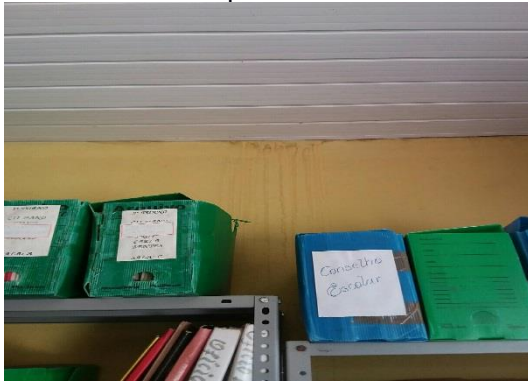
Forro danificado / Infiltrações
