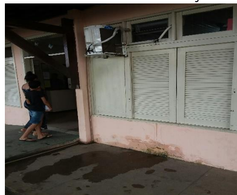
Vazamentos e pintura desgastada
