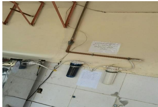
Fiações expostas e improvisadas
