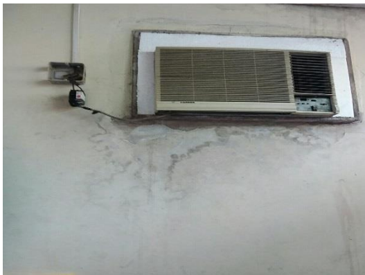
Infiltração e fiação exposta/improvisada
