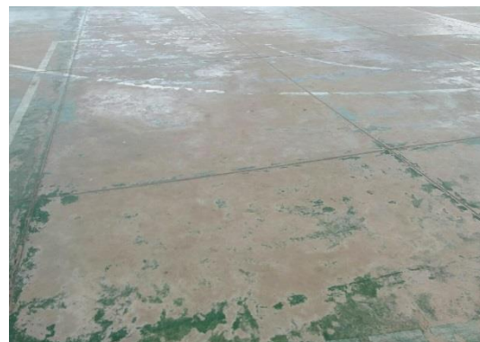
Pintura e marcação desgastadas
