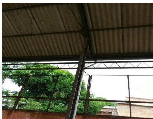
Iluminação insuficiente e tela de proteção danificada
