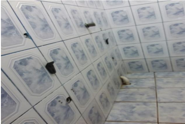
Impropriedades com equipamentos sanitários e inexistência de mictório
