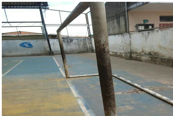
Traves de futsal e handebol danificadas e sem rede
