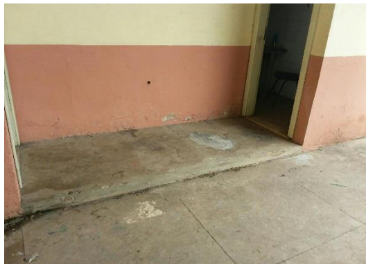
Restrição de acesso para PcD
