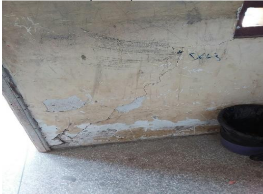
Rachaduras e pintura danificada
