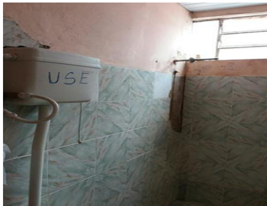
Revestimento e chuveiro danificados
