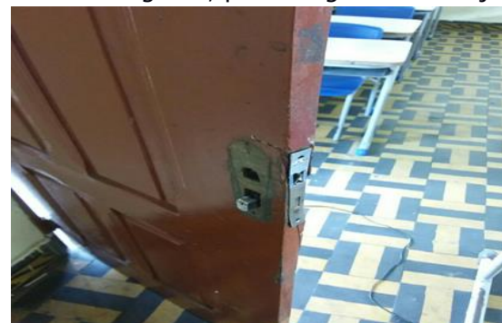
Maçaneta da porta danificada
