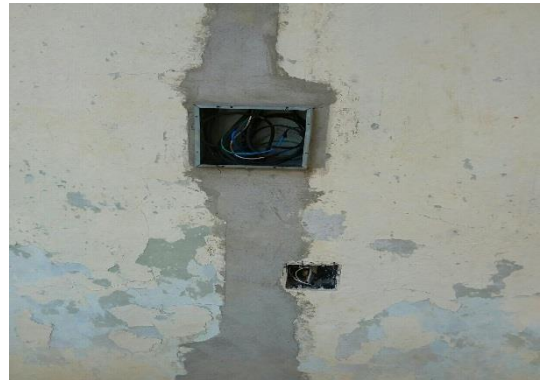
Fiações expostas e pintura danificada
