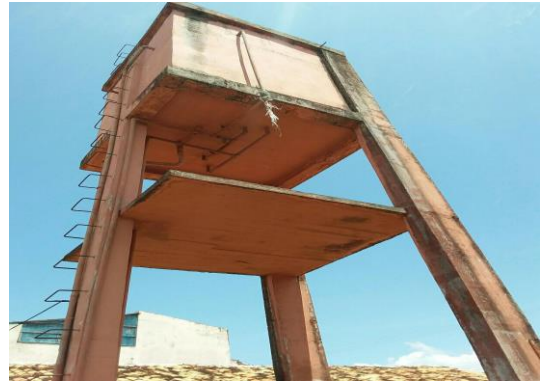
Caixa d'água necessita reparos
