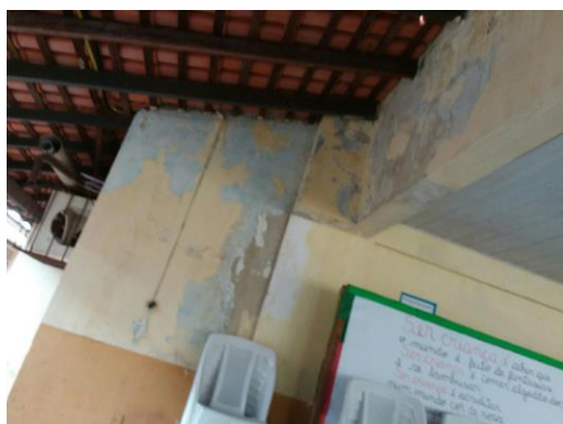
Infiltrações e pintura desgastada
