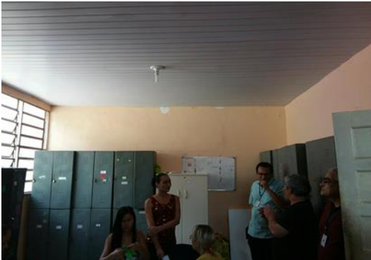
Lâmpada queimada e armários danificados
