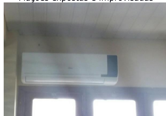
Ar condicionado danificado
