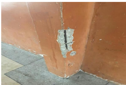
Pintura desgastada e queda de reboco com ferragem exposta
