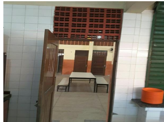
Ventilação insuficiente e inexistência de tela de proteção nas aberturas externas
