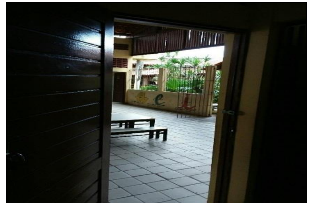
Tela de proteção nas aberturas externas inexistente
