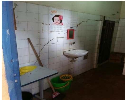
Impropriedades com torneira e lavatório
