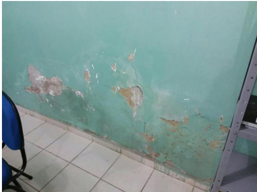
Infiltração de solo e pintura danificada
