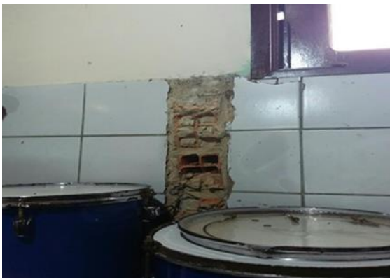
Queda de reboco
