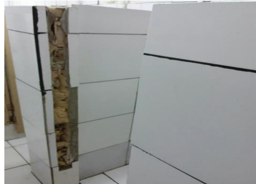
Revestimentos danificados e queda de reboco
