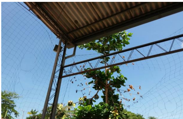
Iluminação insuficiente e tela de proteção danificada
