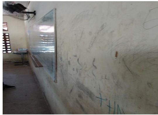
Pintura e quadro danificados e sala suja
