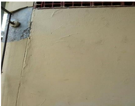
Queda de reboco e pintura danificada
