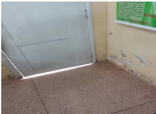
Infiltração e pintura danificada
