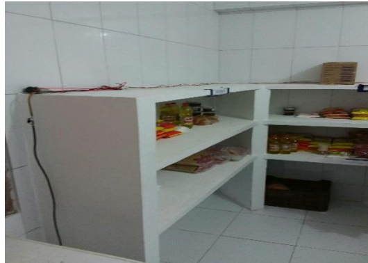
Fiações expostas e improvisadas
