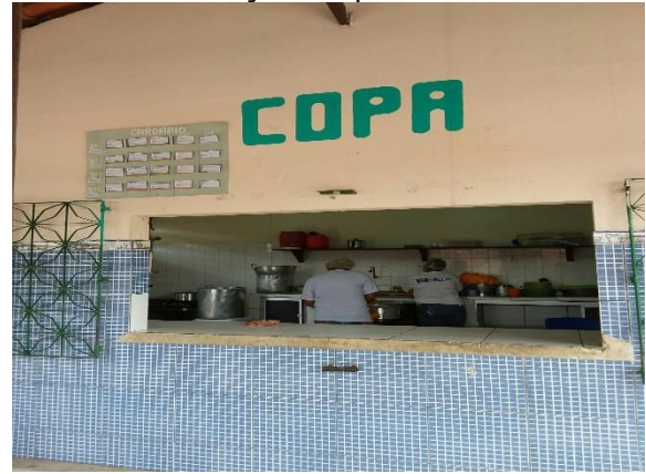
Impropriedades no revestimento e fechamento
