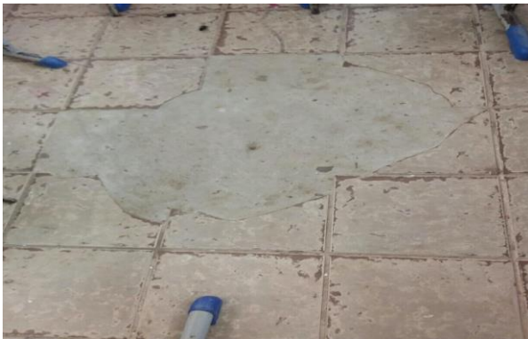
Piso desgastado e danificado
