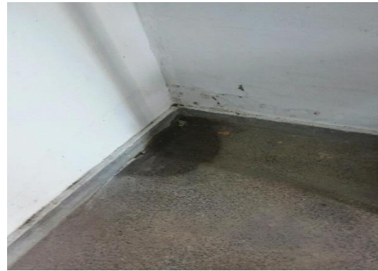
Infiltrações e acúmulo de água
