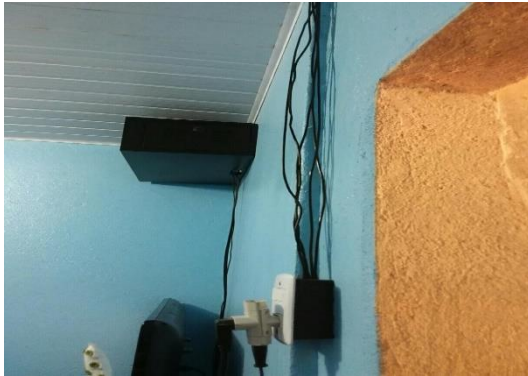
Fiações expostas e improvisadas
