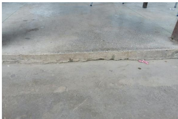
Restrição de acesso para Pcd
