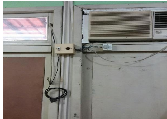
Fiações expostas e improvisadas
