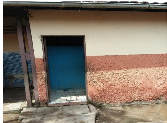
Limitação de acesso a PcD
