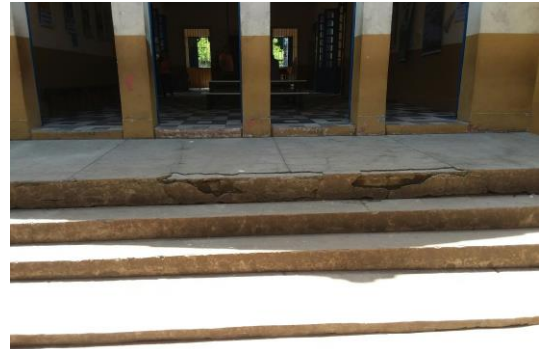
Piso desgastado e restrição de acesso a PcD
