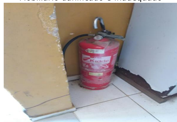
Extintor vencido e pintura desgastada
