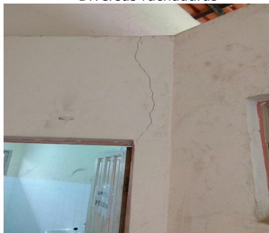
Rachadura e infiltrações
