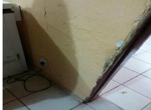
Revestimentos e pintura danificados
