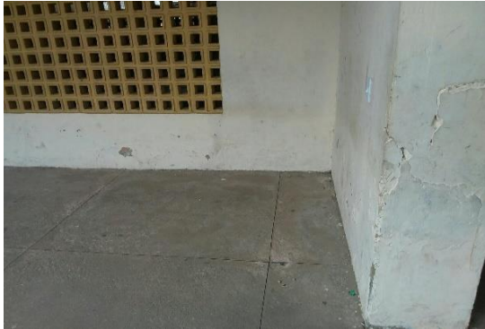
Pintura danificada e divisória inadequada para acústica
