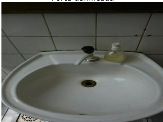
Impropriedade com torneiras
