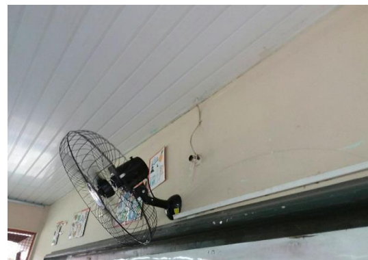
Fiações expostas e improvisadas
