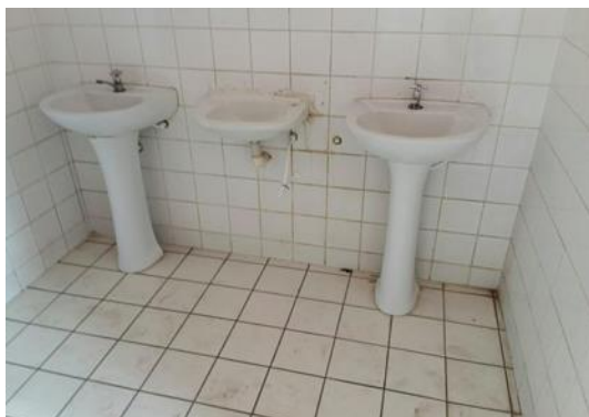
Inexistência de torneira e impropriedades com lavatórios
