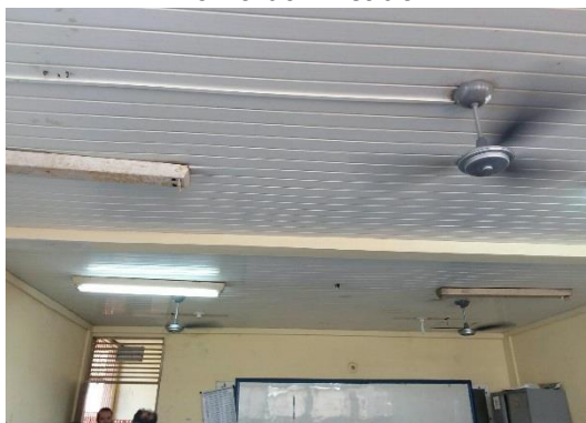
Lâmpadas ausentes, forro danificado e fiação exposta
