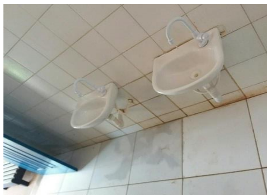
Impropriedades com torneiras
