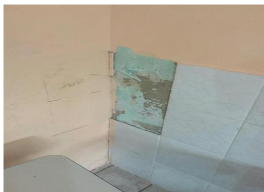
Revestimentos danificados e queda de reboco
