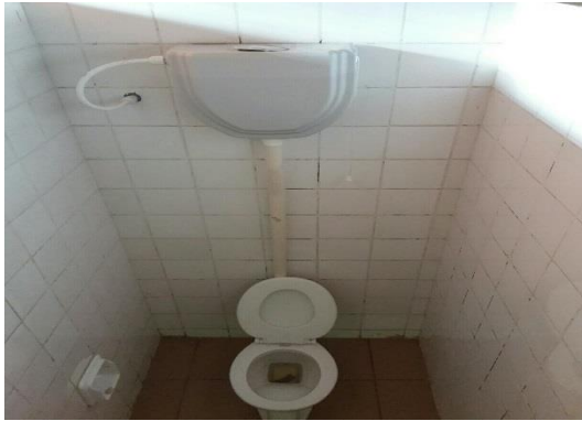
Impropriedades com o vaso sanitário
