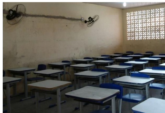
Mobiliário danificado e pintura desgastada
