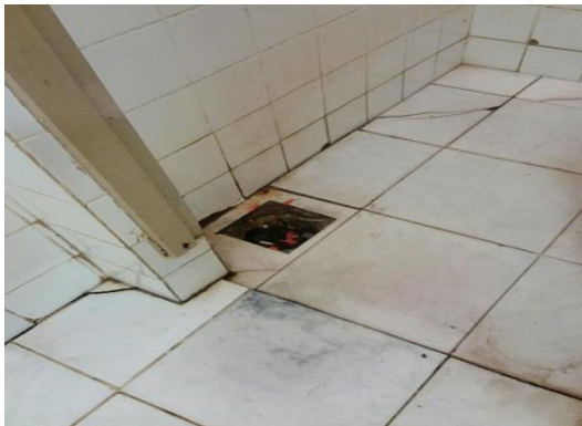
Piso danificado / Rachaduras
