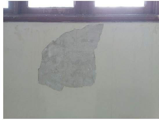
Queda de reboco e pintura danificada
