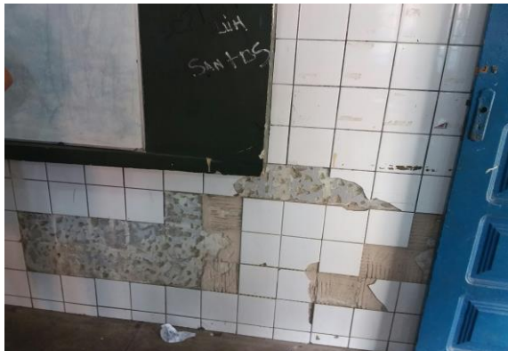
Revestimentos danificados e queda de reboco
