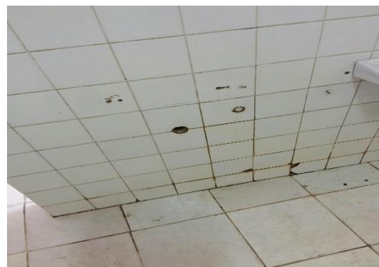
Impropriedades com torneiras, inexistência de lavatório e parede danificada
