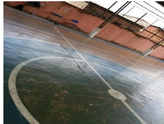
Pintura e marcação de linhas desgastadas
