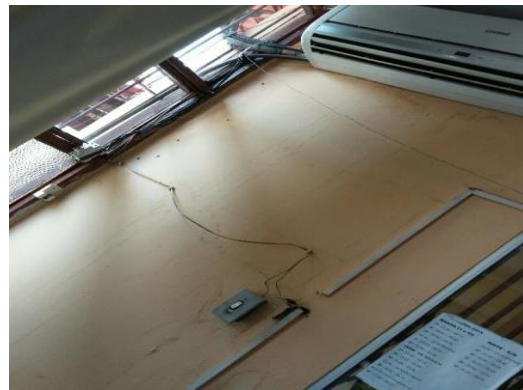
Fiações expostas e improvisadas
