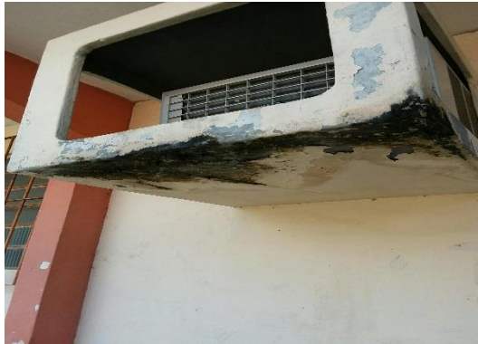
Infiltrações e pintura danificada
