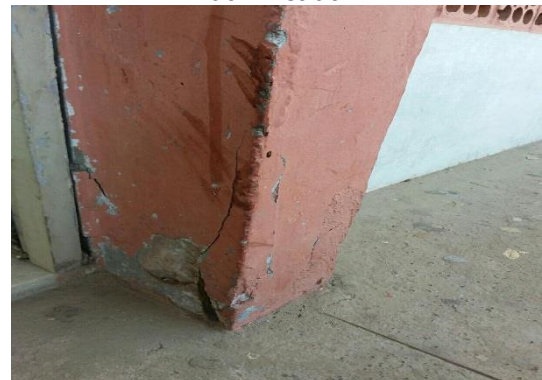
Rachadura e queda de reboco com ferragem exposta
