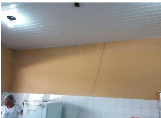
Infiltrações, pintura danificada e fiação exposta e improvisada
