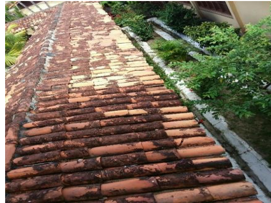
Cobertura danificada e goteiras
