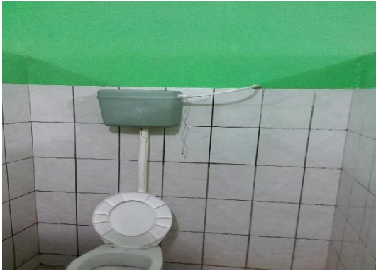
Impropriedades com vaso sanitário
