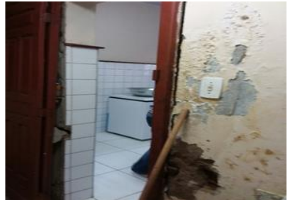
Infiltrações, queda de reboco, porta danificada e inexistência de revestimento
