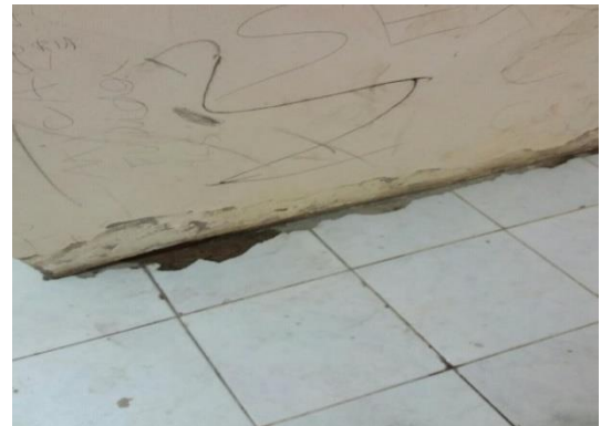
Piso, pintura danificados e Rachaduras
