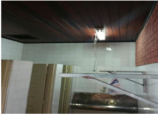
Iluminação insuficiente, forro danificado e fiação exposta
