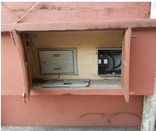
Quadro elétrico sem tampa
