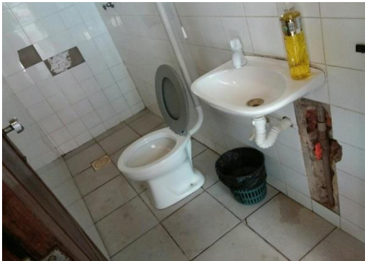
Impropriedades na torneira, lavatório e nos revestimentos
