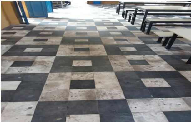
Piso desgastado e sujo
