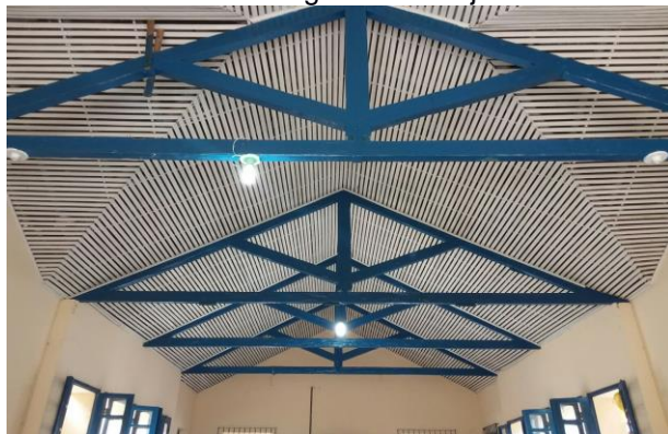
Lâmpadas inexistentes e Iluminação insuficiente
