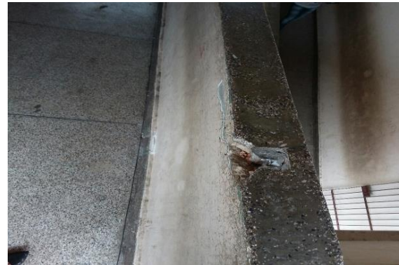
Ferragem exposta no corre mão da escada
