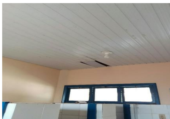
Janelas e forro danificados
