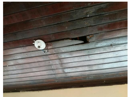
Fiações expostas / improvisadas
