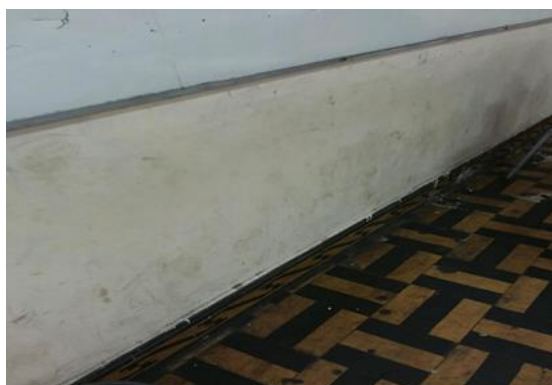
Pintura desgasta, piso desgastado e sujo
