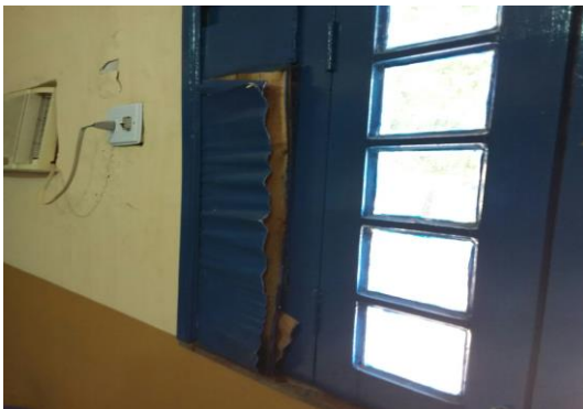
Revestimentos danificados e queda de reboco
