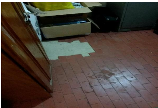
Piso desgastado e danificado
