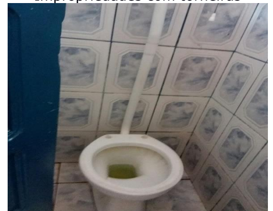
Vaso sanitário sem assento
