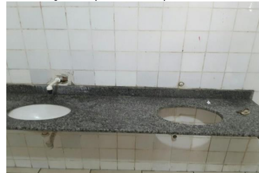
Impropriedades com torneiras e lavatório
