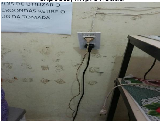
Fiações expostas e improvisadas
