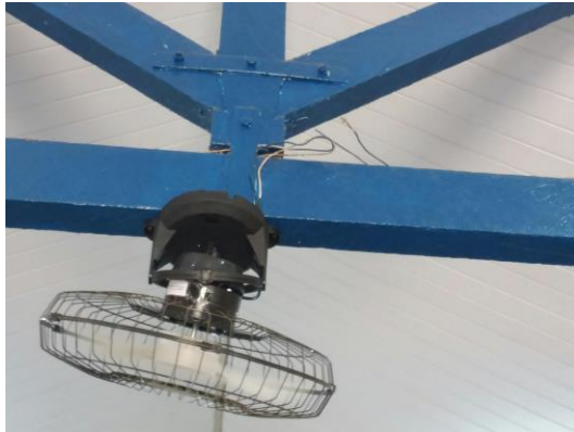
Fiações expostas e improvisadas
