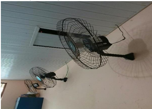
Fiações expostas e forro danificado
