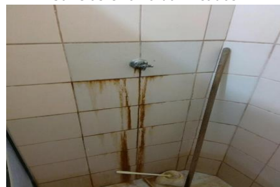
Impropriedades no registro e vazamentos
