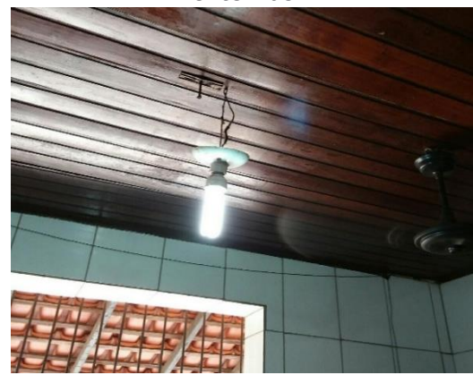
Fiações Expostas e improvisadas
