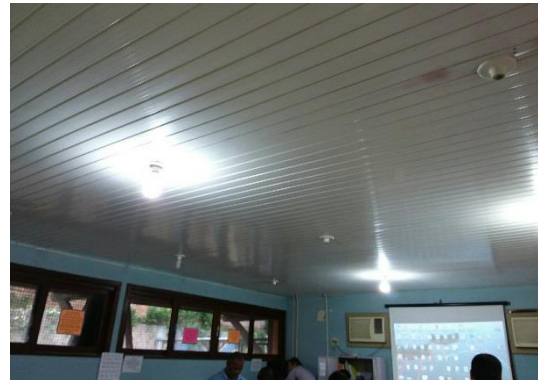
Inexistência de lâmpadas
