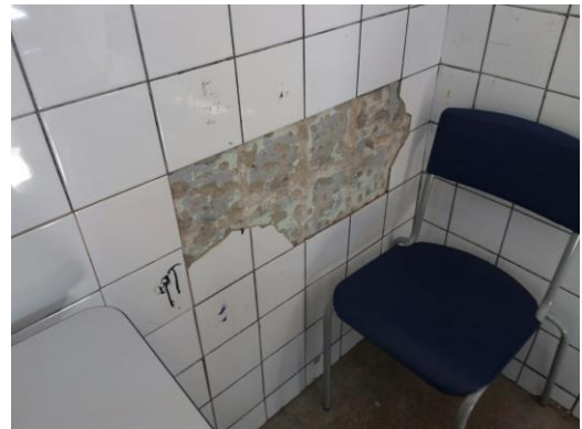
Revestimentos danificados e queda de reboco
