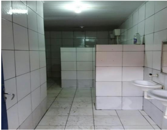
inexistência de ventilação externa
