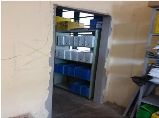
Pintura danificada, fiação exposta e piso desgastado
