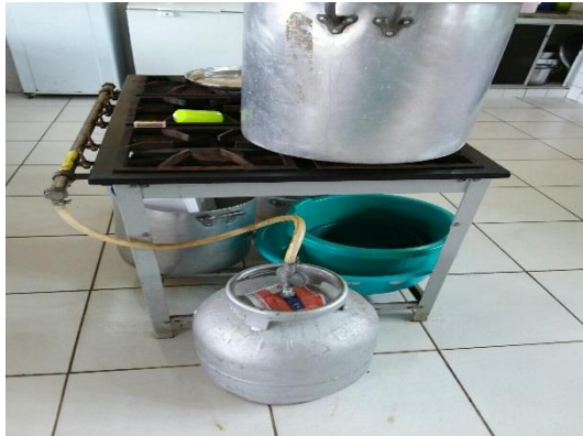
Botijão de gás em local inadequado
