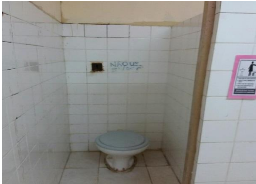
Impropriedades com vaso sanitário
