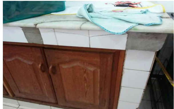
Rachaduras e revestimentos danificados
