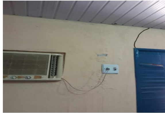
Infiltrações, ar condicionado danificado e presença de casa de cupim
