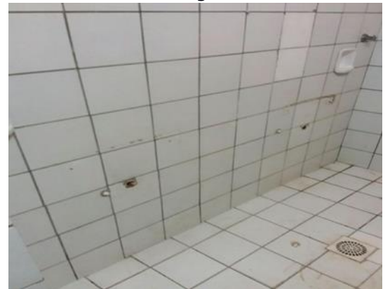
Inexistência de mictório e vaso sanitário
