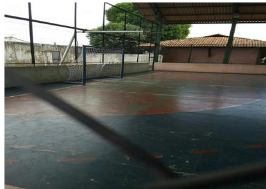
Piso, pintura/marcação, tabelas e aro de basquete danificados
