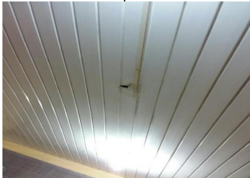
Forro danificado e fiação exposta
