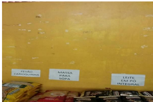
Inexistência de revestimento e pintura danificada
