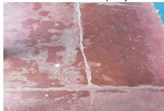
Piso danificado e desgastado
