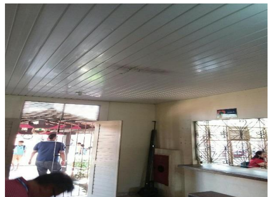
Lâmpada ausente e ventilação insuficiente
