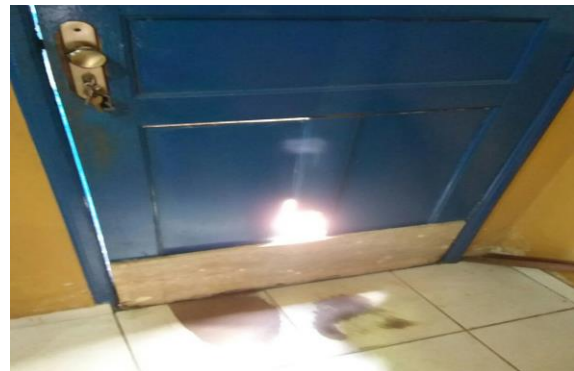
Piso desgastado e porta danificada
