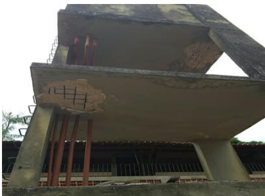
Queda de reboco com ferragem expostas
