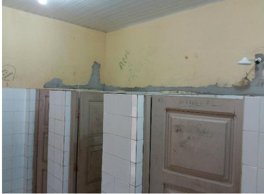
Revestimentos danificados e pintura desgastada
