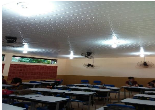
Paredes das salas dificultam a acústica
