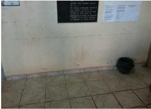
Pintura e piso desgastado
