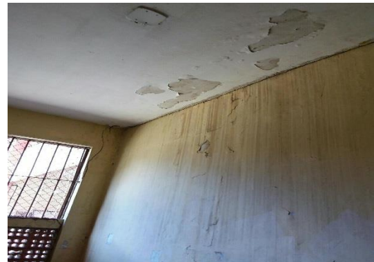
Infiltração, rachadura e pintura danificada
