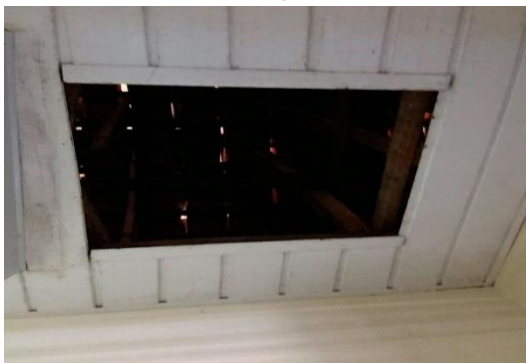
Telhado e forro danificados
