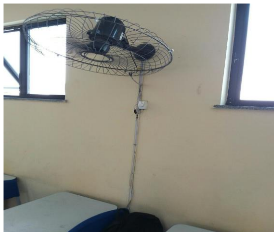
Fiações expostas e improvisadas
