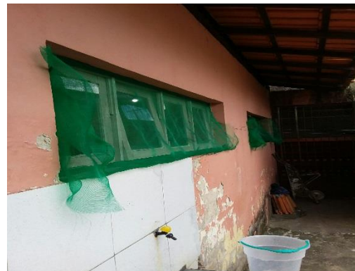
Pintura, janelas e tela de proteção danificadas
