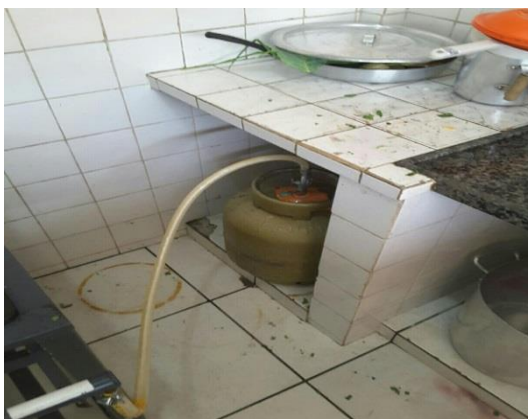
Botijão de gás em local indevido
