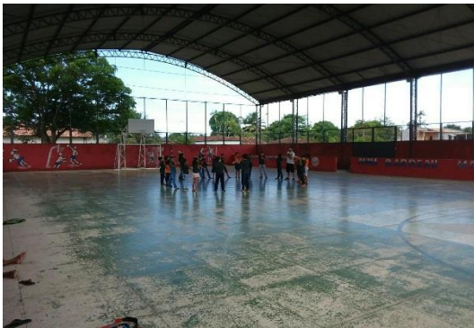
Pintura e marcação de linhas desgastadas
