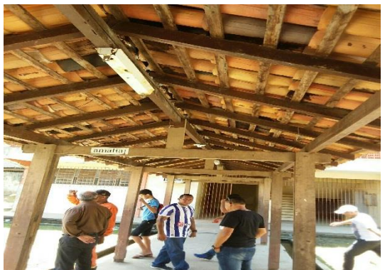
Iluminação insuficiente e lâmpadas inexistentes
