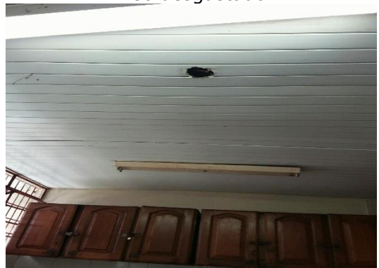
Forro danificado e lâmpada ausente
