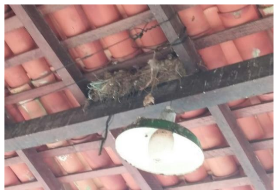
Fiação exposta e presença de ninho de pombos
