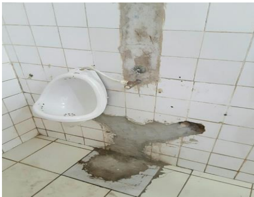
Revestimentos e parede danificados e queda de reboco
