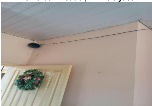
Pintura desgastada / Fiação exposta
