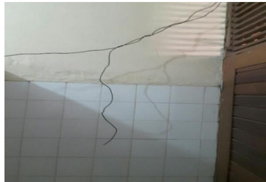
Fiação exposta e improvisadas
