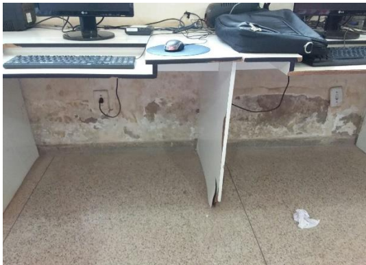
Mobiliário e pintura danificados, infiltração e queda de reboco
