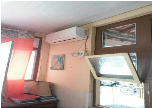
Fiações expostas e improvisadas
