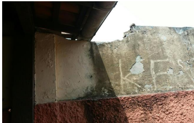
Muro danificado, sem concertina e cerca elétrica
