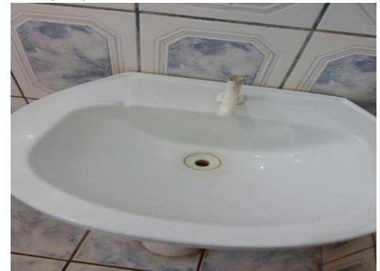
Impropriedades com torneiras
