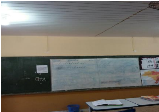
Mobiliário danificado e improvisado
