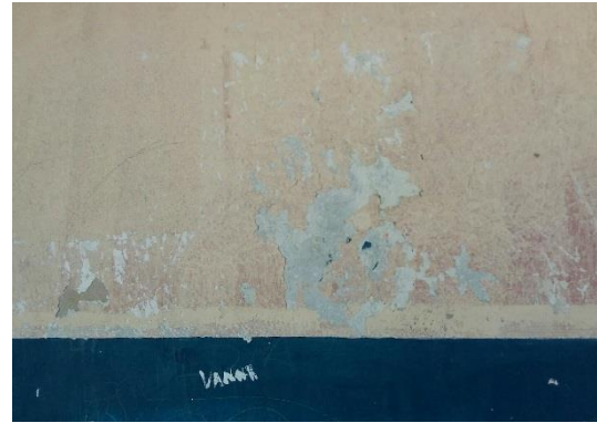
Infiltrações e pintura danificada
