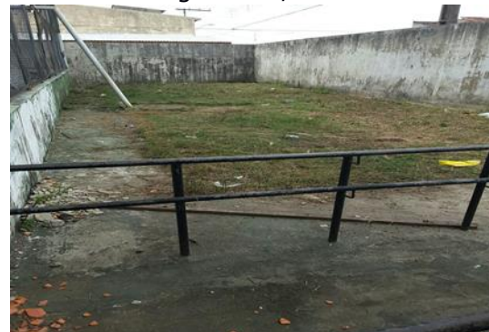
Necessidade de capinação e limpeza
