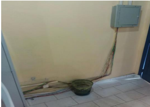
Fiações expostas e improvisadas
