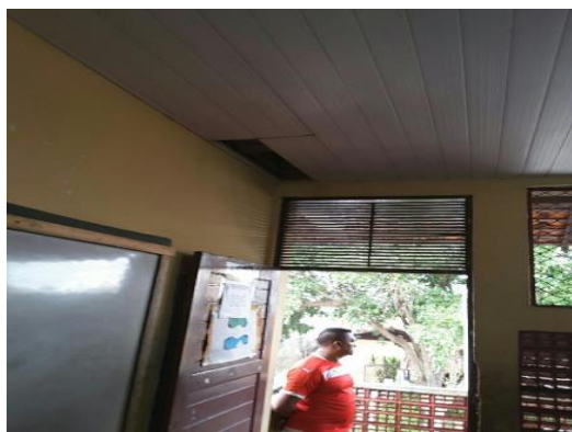
Iluminação insuficiente e forro danificado
