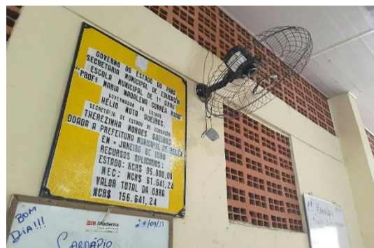
Fiações expostas e improvisadas e Iluminação insuficiente
