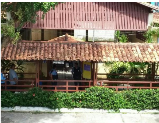
Vulnerabilidade da estrutura física
