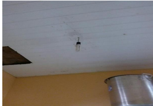
Forro danificado, lâmpada queimada, fiação exposta e inexistência de revestimento
