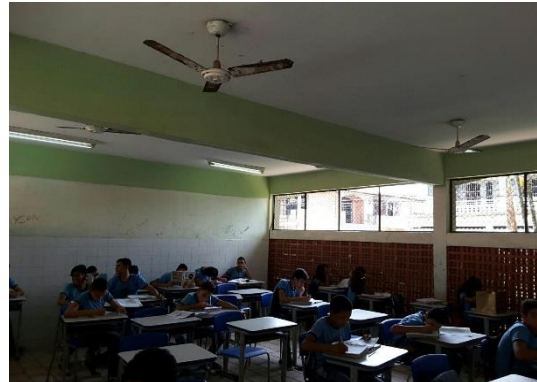
Ventiladores danificados e inexistência de janelas
