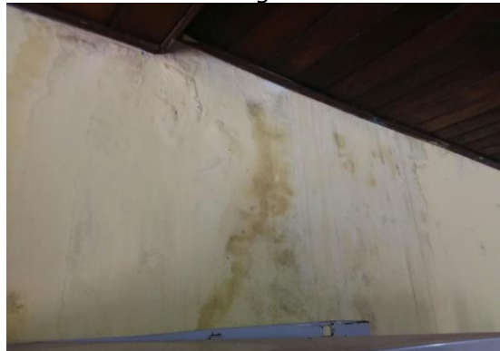
Infiltrações e pintura desgastada
