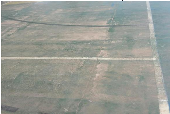
Pintura e marcação desgastadas
