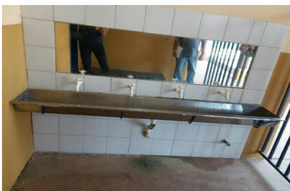
Piso desgastado e vazamentos
