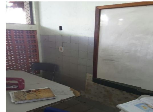
Mobiliários danificados e queda de reboco
