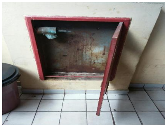
Inexistência de mangueira
