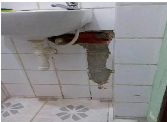
Parede e revestimentos danificados
