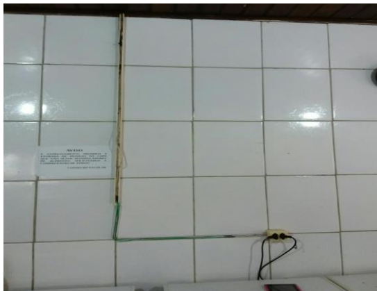
Fiações Expostas e improvisadas
