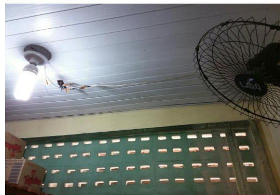
Fiações expostas e improvisadas
