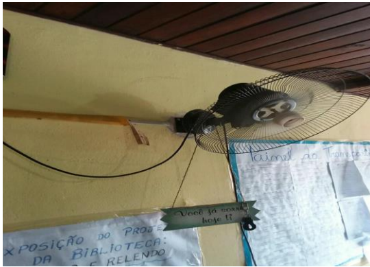
Fiação exposta e improvisada e ventilador danificado
