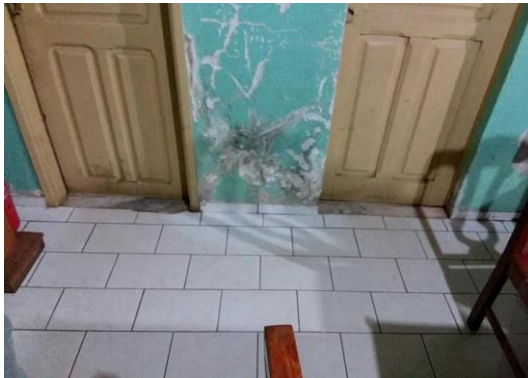
Infiltrações e pintura danificada
