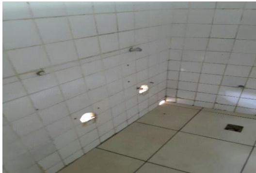
Impropriedades na parede e chuveiro e inexistência de vasos sanitários
