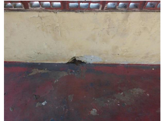
Infiltrações e dreno improvisado
