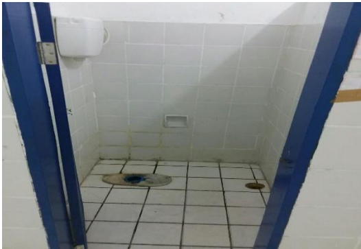
Vaso sanitário inexistente
