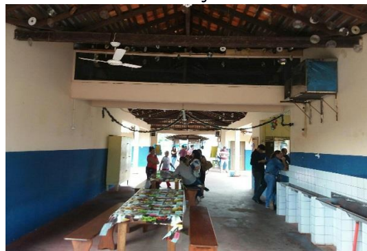
Espaço reduzido e ventilação insuficiente
