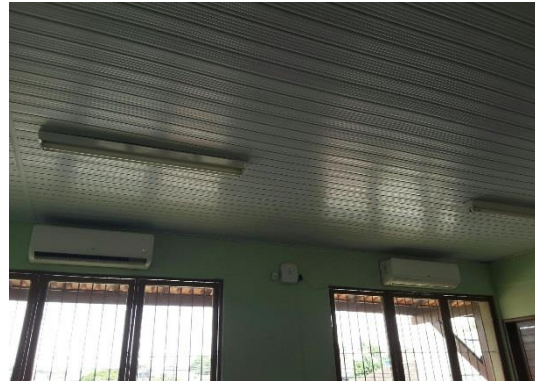
Lâmpadas queimadas e inexistentes
