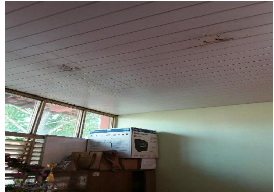
Lâmpadas inexistentes e fiação exposta
