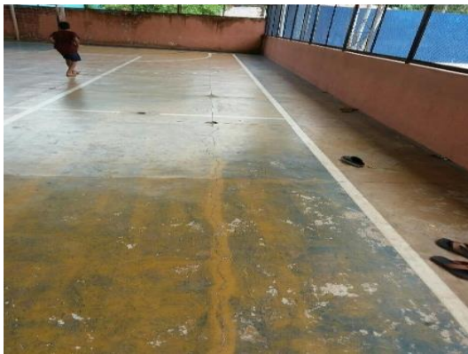
Pintura e marcação de linhas desgastadas
