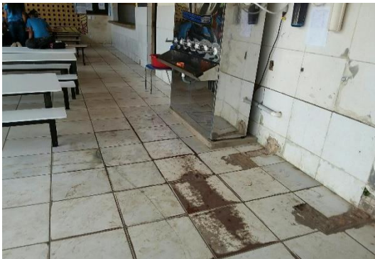
Piso e revestimento danificados
