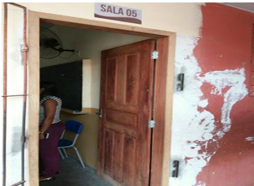
Pintura e revestimentos danificados
