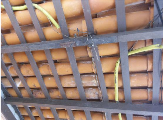
Fiações expostas e improvisadas
