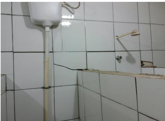
impropriedades no chuveiro
