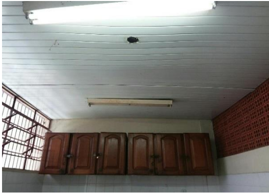
Lâmpadas ausentes e ventilação natural insuficiente
