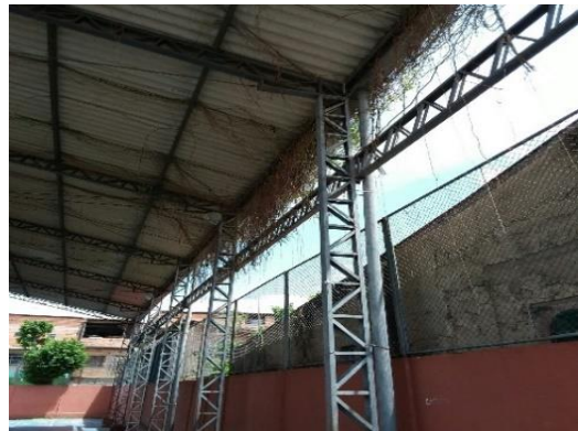
Presença de mato na cobertura da quadra
