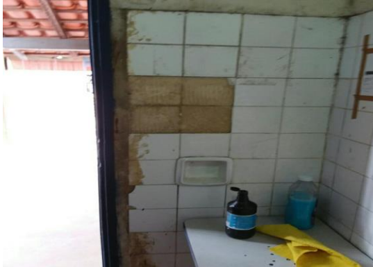
Revestimentos danificados e queda de reboco
