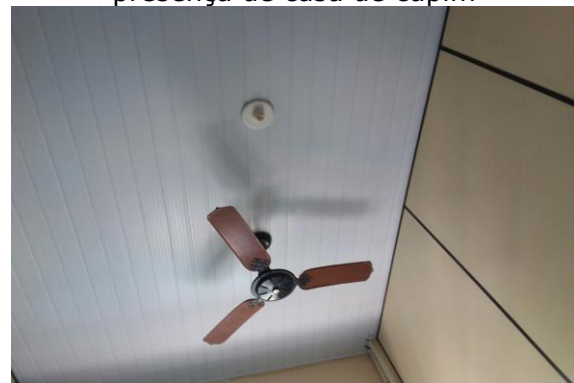
Ventilação insuficiente e lampada queimada
