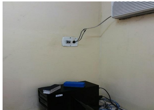
Fiações expostas e improvisadas
