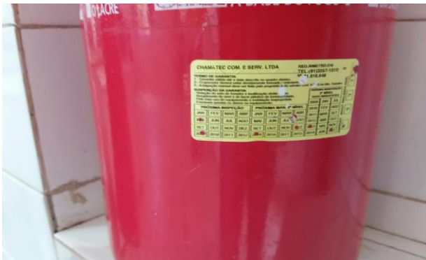
Extintor de incêndio com carga vencida
