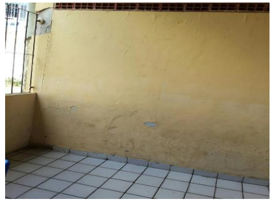
Infiltrações e pintura danificada
