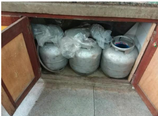
Botijão de gás no ambiente interno e inadequado
