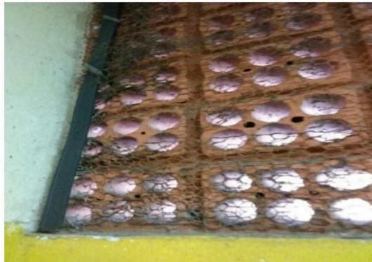
Tela de proteção inadequada e danificada
