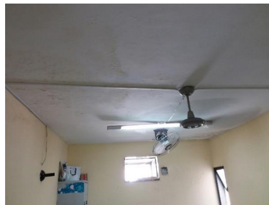
Infiltração, fiação exposta e inexistência de ar condicionado
