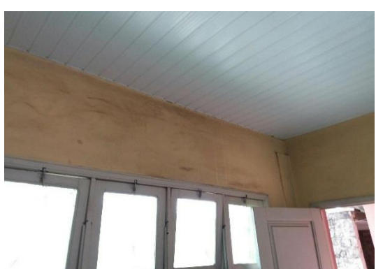
Infiltrações e aberturas externas sem tela de proteção
