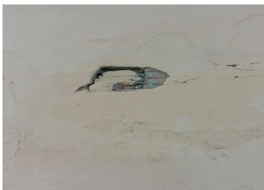
Revestimentos danificados e queda de reboco
