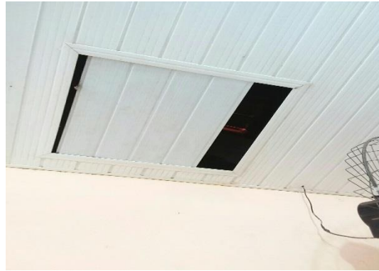
Forro danificado e fiação exposta
