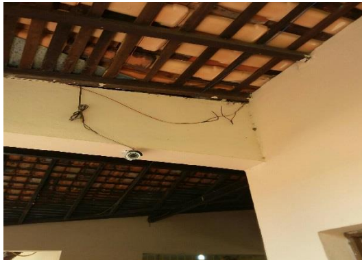
Sistema de CFTV insuficiente
