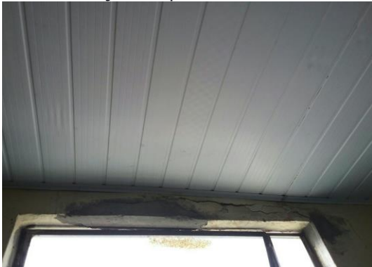
Rachaduras e iluminação insuficiente
