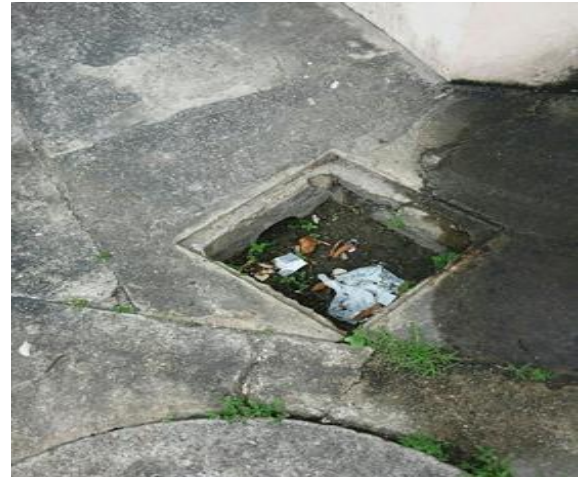
Caixa de passagem entupida
