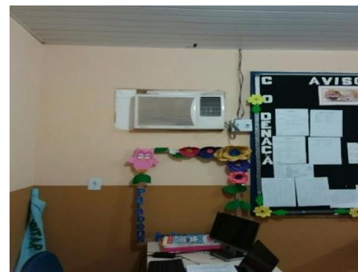
Ar-condicionado danificado e fiação exposta e improvisada
