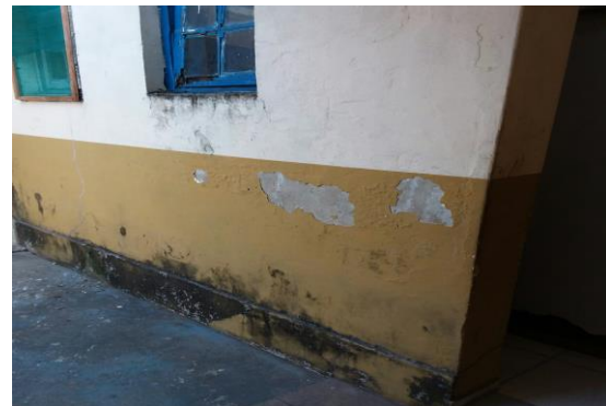
Infiltrações e pintura danificada
