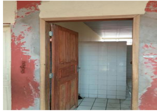
Pintura e revestimentos danificados
