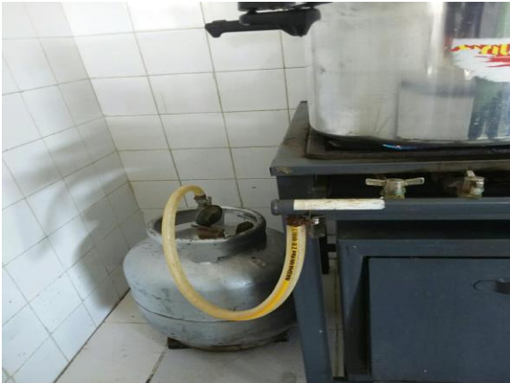
Botijão de gás em local inadequado
