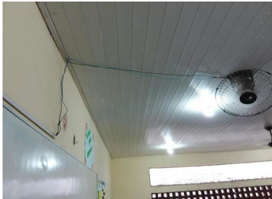
Fiações expostas e improvisadas
