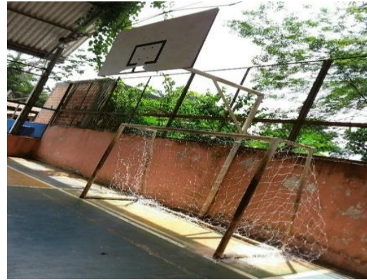
Traves de futsal e handebol danificadas
