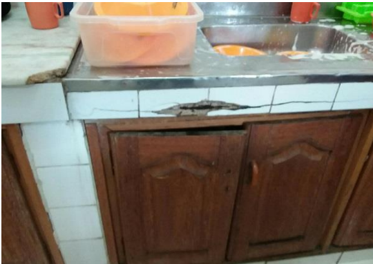
Rachadura, revestimentos e mobiliário danificados
