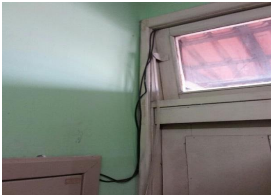
Fiações expostas e improvisadas
