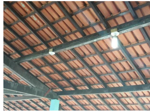
Inexistência de lâmpada
