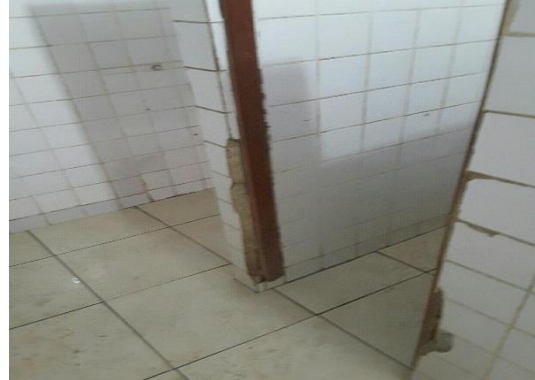
Revestimentos danificados e queda de reboco
