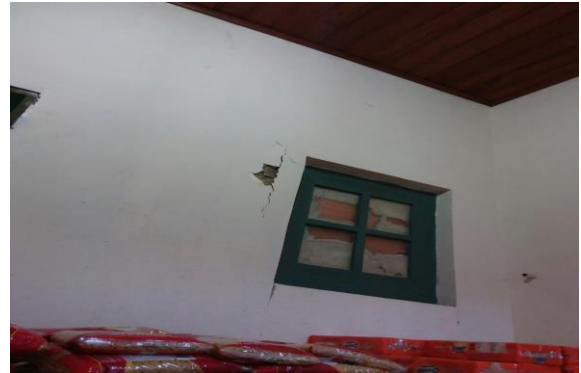
Rachadura, pintura danificada, ventilação natural insuficiente/área de ventilação fechada.
