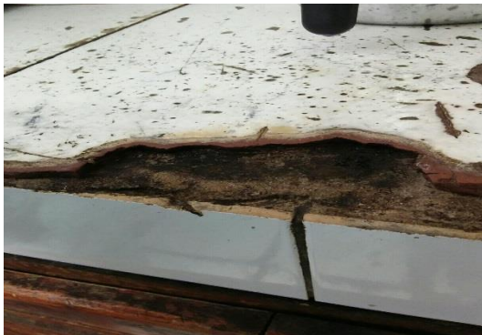
Revestimento e piso danificados e inadequado
