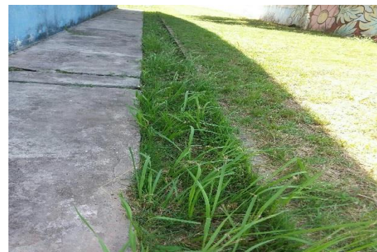
Necessidade de capinação
