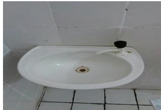
Impropriedades na torneira
