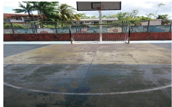
Pintura e marcação de linhas desgastadas
