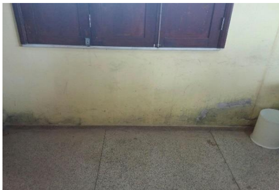
Infiltrações e pintura desgastada
