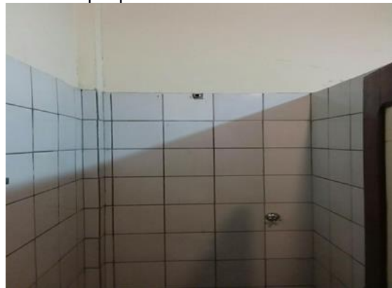
Inexistência de chuveiro
