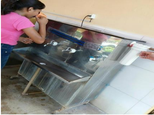
Bebedouro com vazamentos e compartilhamento de copo plástico
