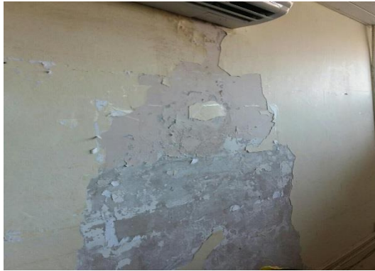
Infiltração, pintura danificada
