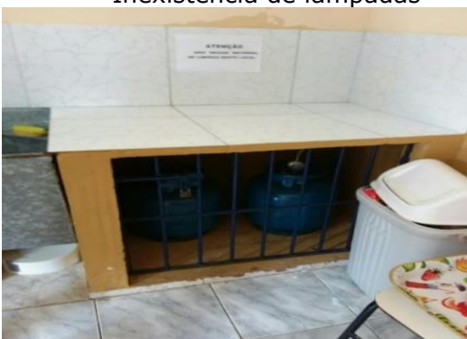
Botijão de gás no ambiente interno
