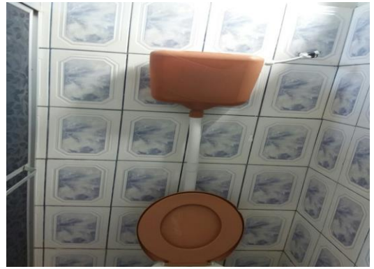
Impropriedades com vaso sanitário
