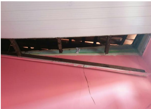
Cobertura e forro danificados
