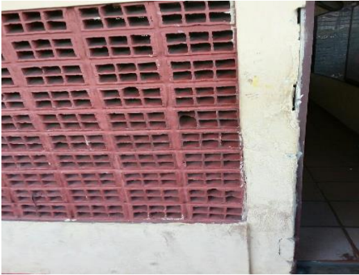
Revestimentos danificados e queda de reboco
