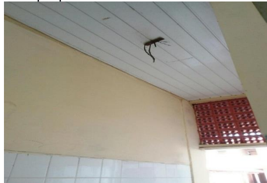
Fiações expostas e improvisadas
