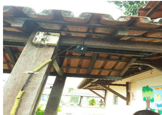
Fiações expostas e improvisadas
