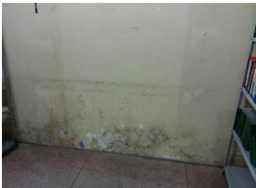
Infiltração e pintura danificada
