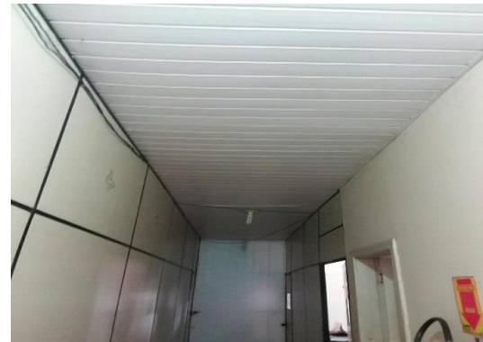
Iluminação insuficiente e fiação exposta
