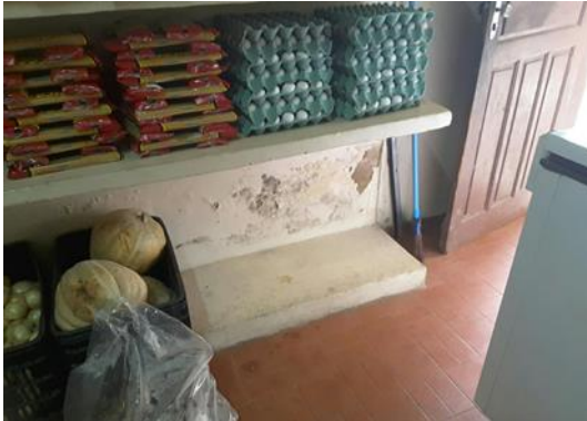
Infiltrações e falta de revestimentos
