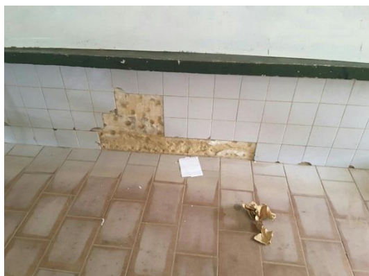
Revestimentos danificados e queda de reboco
