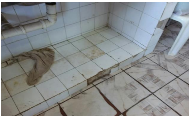
Revestimentos danificados e vazamentos
