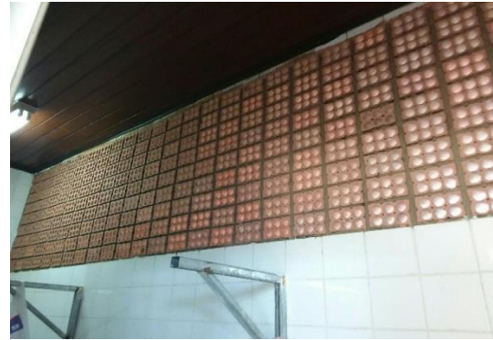
Ventilação natural insuficiente
