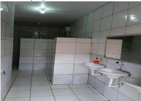
Restrição/limitação de acesso para PcD
