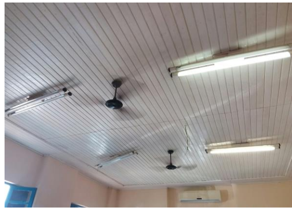
Fiações expostas, Lâmpadas queimadas e ar condicionado danificado.
