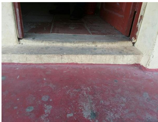
Restrição e limitação de acesso a PcD
