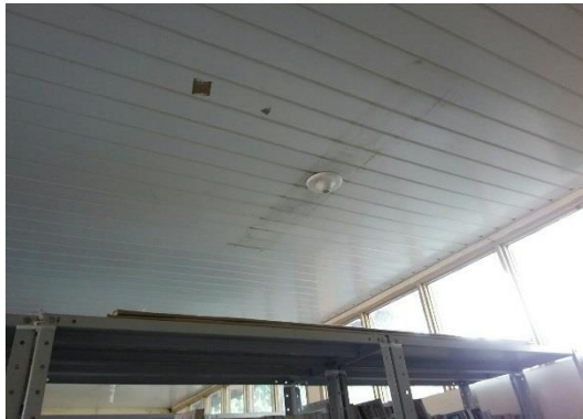
Inexistência de lâmpada
