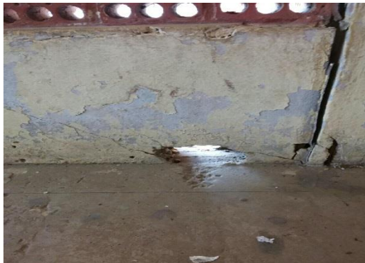
Pintura, parede e piso danificados
