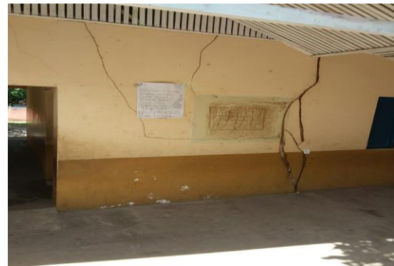
Presença de casa de cupim, infiltrações e pintura desgastada
