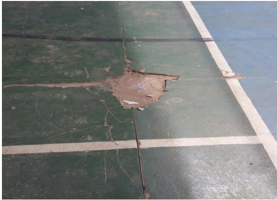
Piso danificado e inadequado
