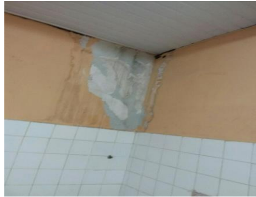
Infiltrações, forro e pintura danificados
