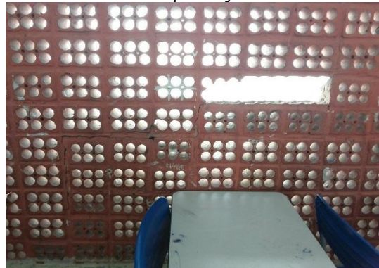
Rachadura e parede danificada
