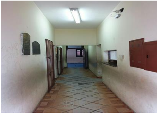
Pintura e piso desgastados
