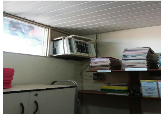
Ar-condicionado danificado e fiação exposta
