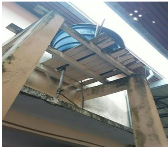
Base de madeira danificada
