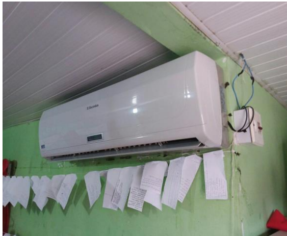
Fiações expostas e improvisadas
