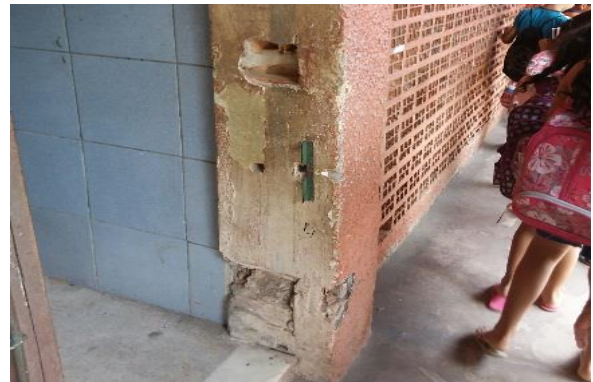
Queda de reboco
