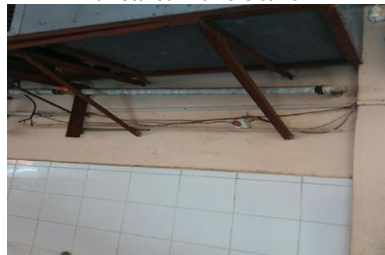
Fiações expostas e improvisadas
