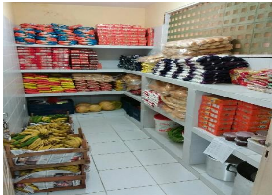
Infiltração e impropriedades no revestimento da parede
