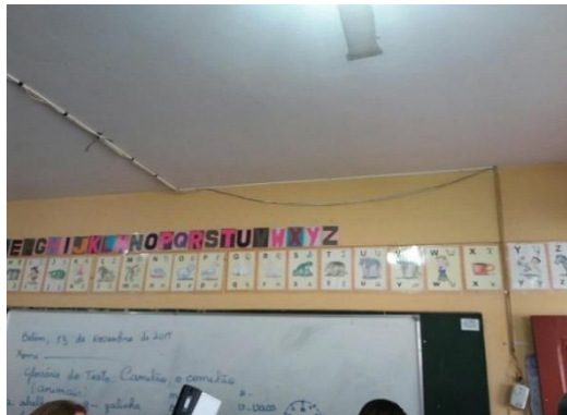
Fiações expostas e improvisadas
