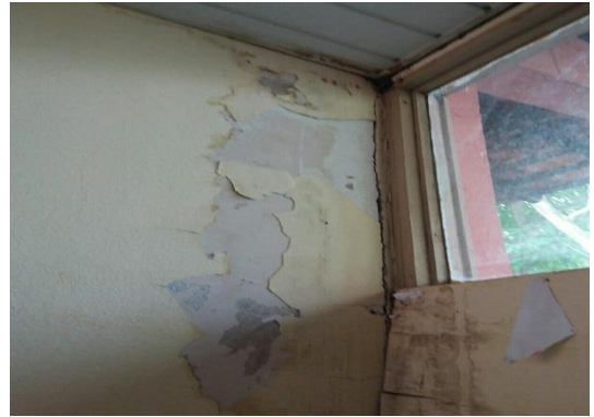
Infiltração e rachadura
