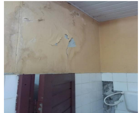
Infiltrações, pintura e revestimento danificados
