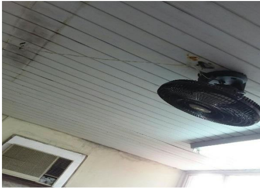
Ar-condicionado e ventilador danificado e fiação exposta
