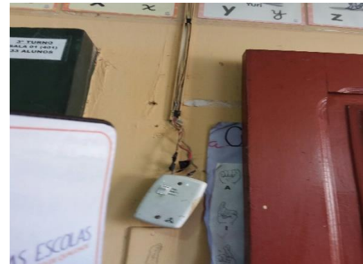
Fiações expostas e improvisadas
