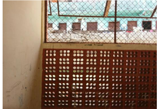
Janela e tela de proteção danificadas
