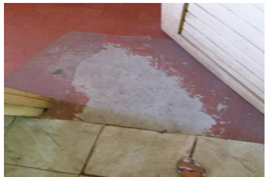
Piso desgastado e danificado
