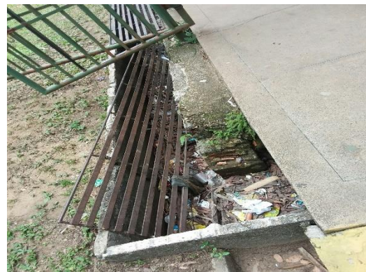
Necessidade de manutenção
