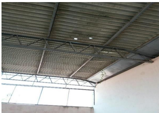
Cobertura danificada / telha furada
