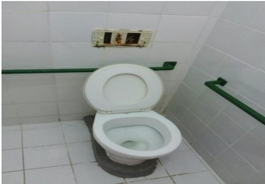
Impropriedades no vaso sanitário
