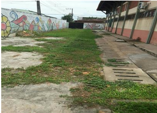
Cerca elétrica inexistente
