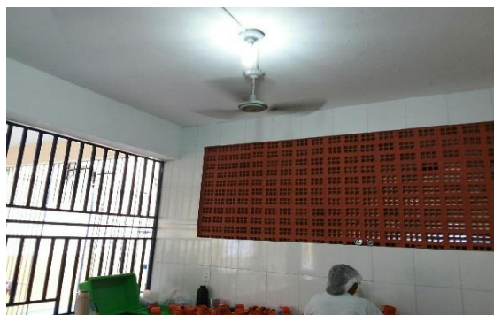
Tela de proteção nas aberturas externas ausente e existência de ventiladores
