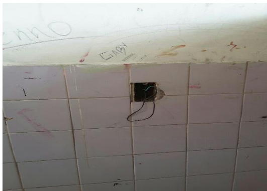
Fiações expostas / improvisadas
