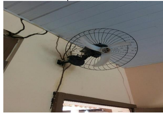
Ventilador danificado e presença de casa de cupim
