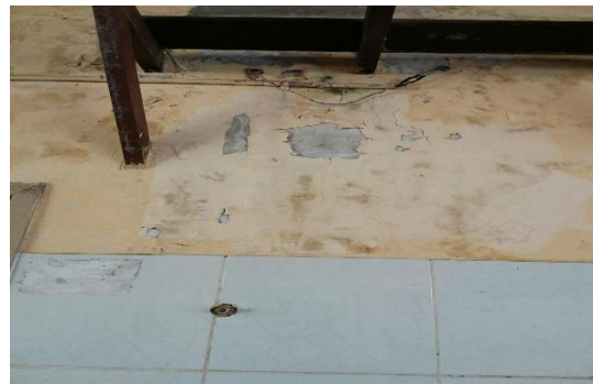
Infiltração, pintura desgastada e fiação exposta
