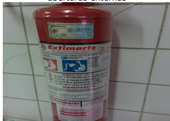
Extintor de incêndio com carga vencida
