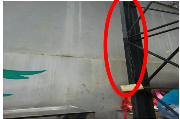
Fiações expostas e improvisadas
