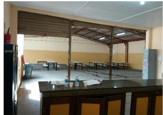
Aberturas externas sem tela de proteção
