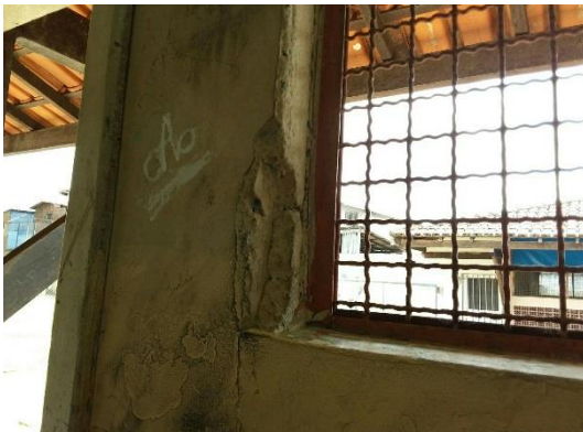
Queda de reboco
