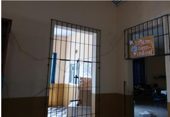
Fiações expostas / improvisadas
