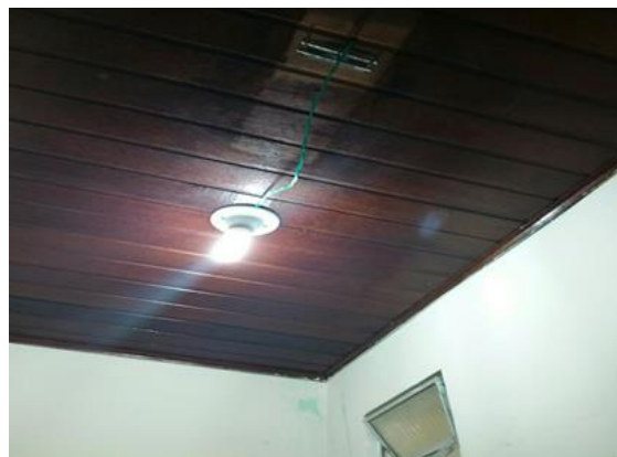
Iluminação insuficiente e Fiação exposta
