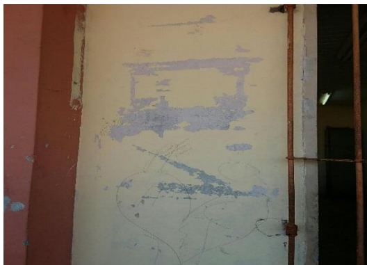
Pintura desgastada e danificada
