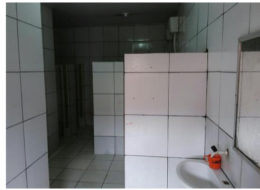
Inexistência de Lâmpada e ventilação externa
