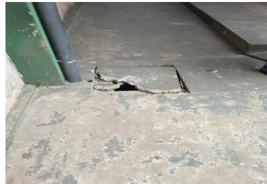
Piso desgastado / danificado
