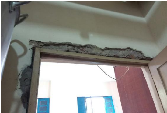
Revestimentos danificados e queda de reboco
