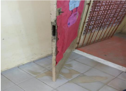
Porta danificada e piso desgastado
