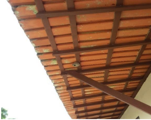
Existência de casa de caba no telhado
