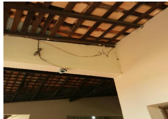
Fiações expostas e improvisadas
