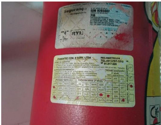
Extintor de incêndio fora da validade
