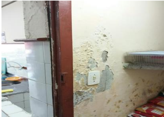
Infiltrações e pintura danificada
