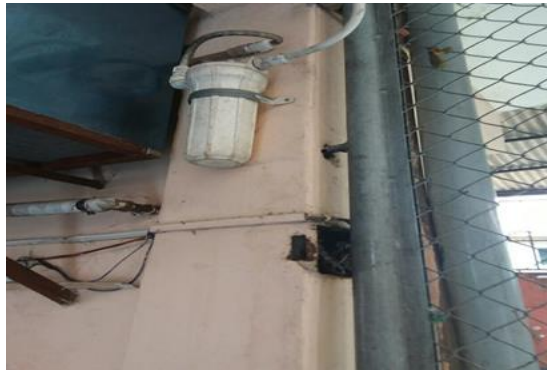
Fiações expostas e improvisadas
