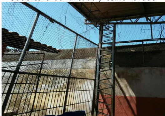
Tela de proteção e telhado danificadas
