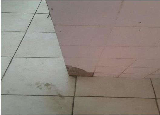
Revestimentos danificados e queda de reboco
