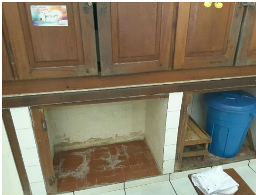
Portas danificadas e inexistentes
