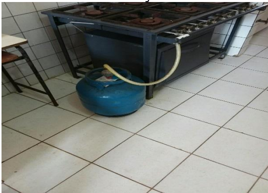
Botijão de gás em local interno e inadequado
