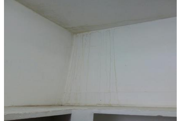
Infiltrações e pintura danificada
