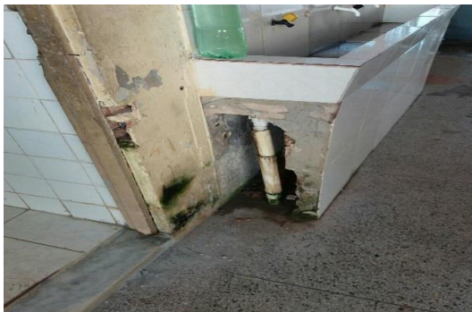
Revestimentos danificados e queda de reboco
