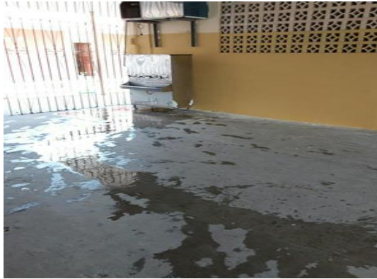
Bebedouro com vazamento
