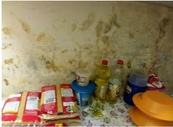
Infiltrações e inexistência de revestimento
