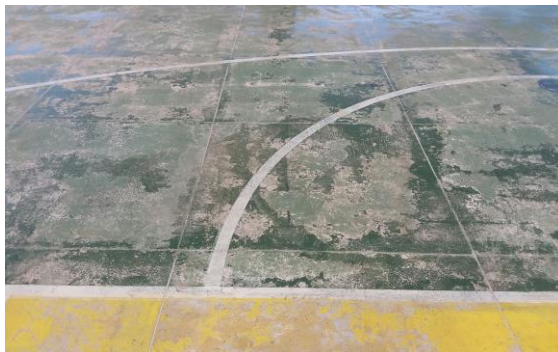
Pintura e marcação de linhas desgastadas
