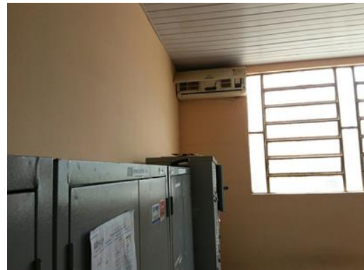
Ar condicionado danificado
