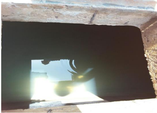
Caixa d'água e cisterna necessitam manutenção
