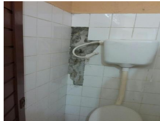
Revestimentos danificados e queda de reboco
