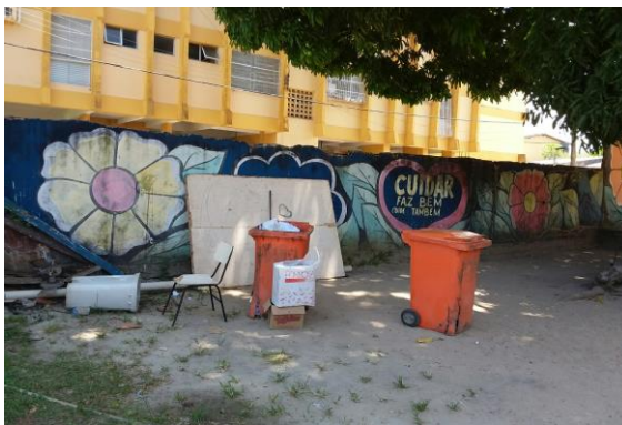
Muro baixo e danificado
