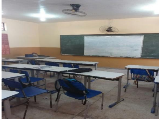
Mobiliário danificado e improvisado e piso danificado e sujo
