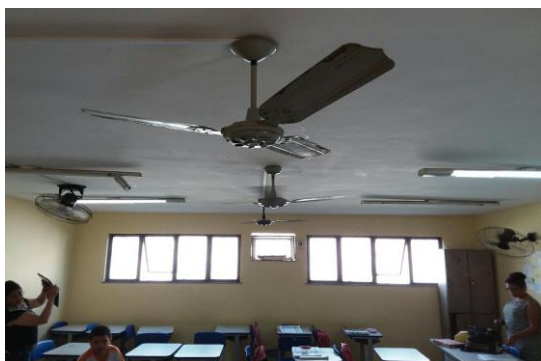
Iluminação insuficiente e lâmpadas queimadas
