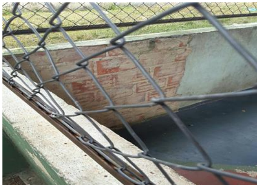
Revestimentos danificados/queda de reboco
