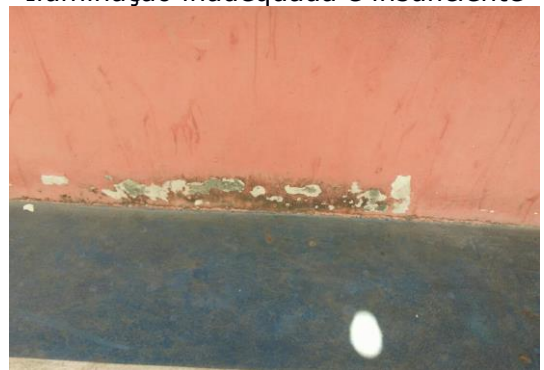
Infiltração e pintura desgastada
