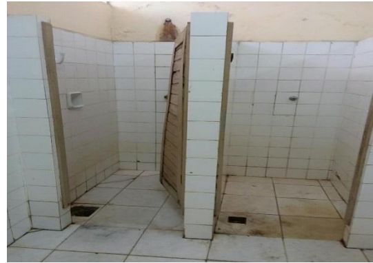
Portas danificadas e ausentes e impropriedades com piso e chuveiro
