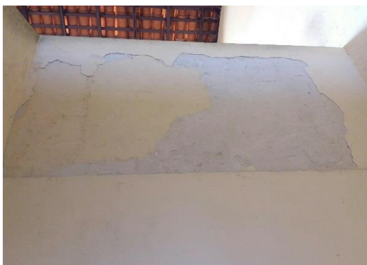
Infiltração e pintura danificada
