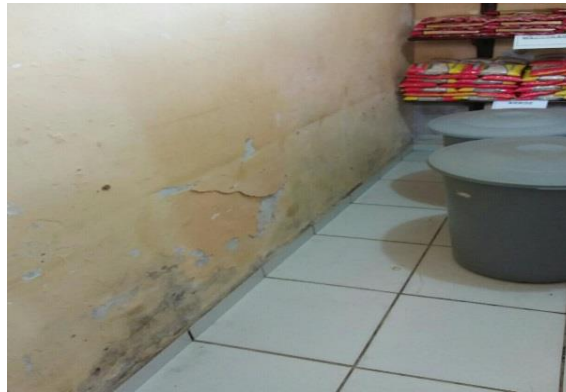
Infiltrações, pintura e inexistência de revestimento nas paredes
