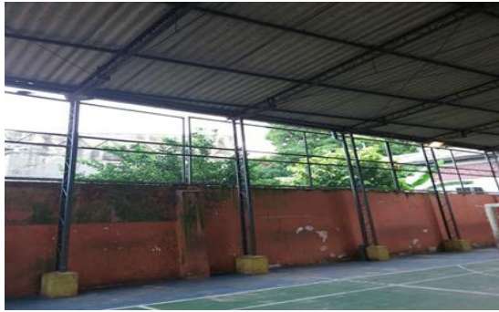
Pintura e marcação de linhas desgastadas
