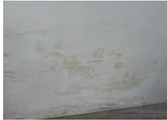
Infiltração e pintura desgastada
