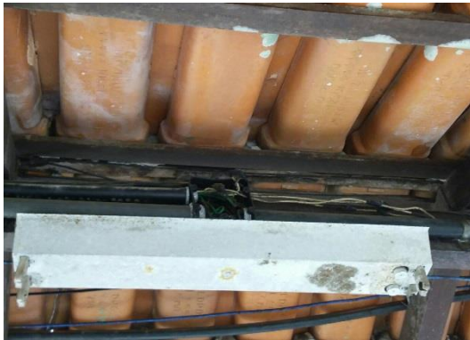
Lâmpada inexistente e fiação exposta
