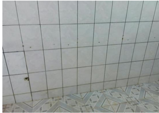
Inexistência de mictório
