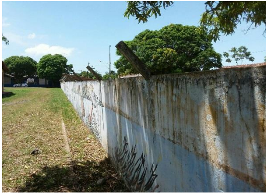
Cerca danificada e concertina inexistente
