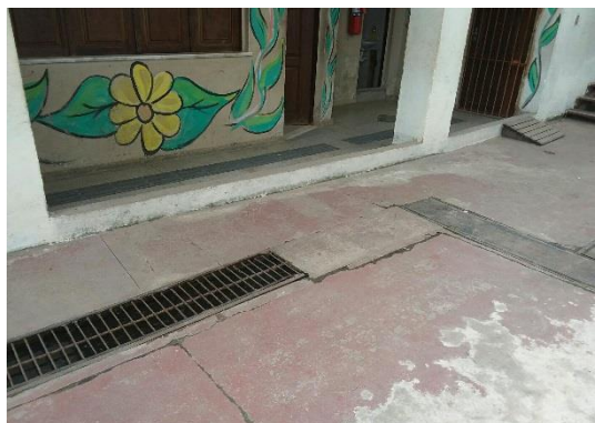
Limitação de acesso para PcD e sistema de drenagem inadequado
