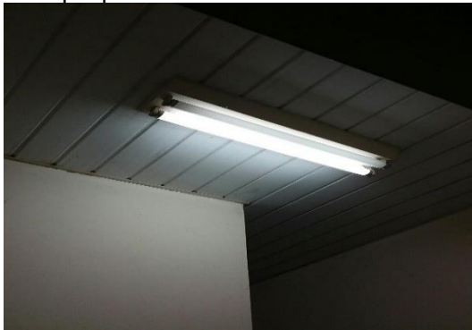
Iluminação insuficiente e lâmpada queimada
