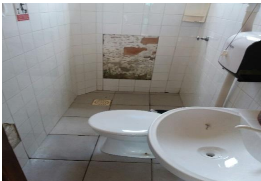
Impropriedades no revestimento
