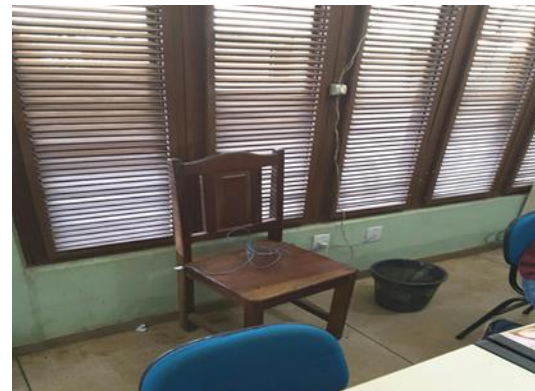
Fiações expostas e improvisadas
