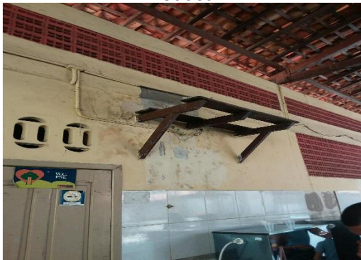
Infiltração e fiação exposta
