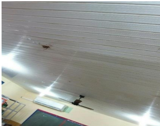
Ar-condicionado e forro danificados e fiação elétrica exposta
