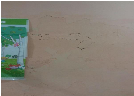
Rachadura e pintura danificada
