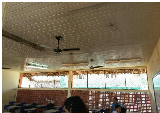
Lâmpadas ausentes, forro danificado e fiação exposta
