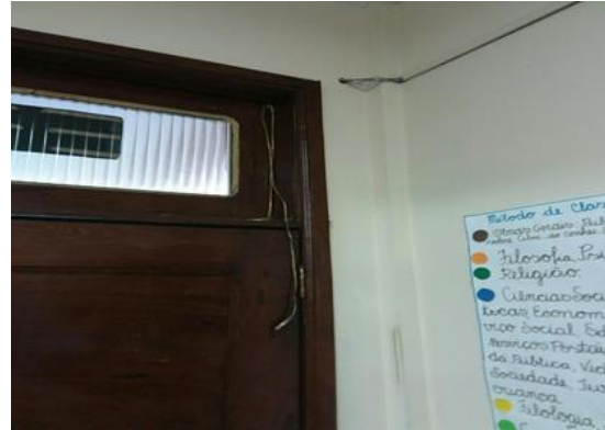
Fiação expostas e improvisadas
