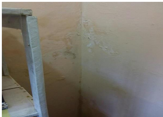
Infiltrações e pintura danificada
