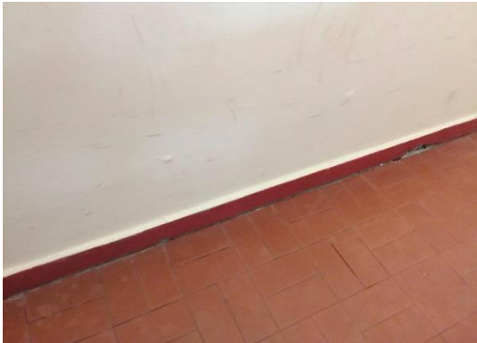
Pintura e piso danificados
