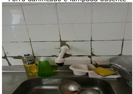
Infiltrações e revestimento danificado
