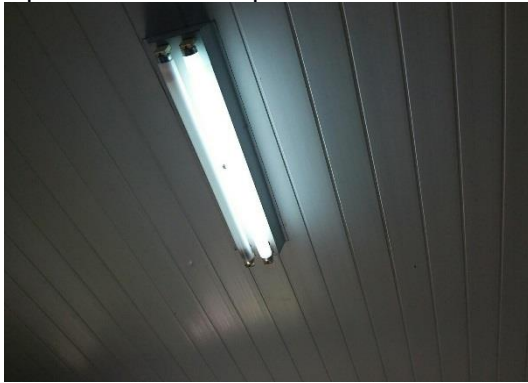
Lâmpada queimada e iluminação insuficiente
