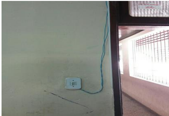
Fiações expostas e improvisadas
