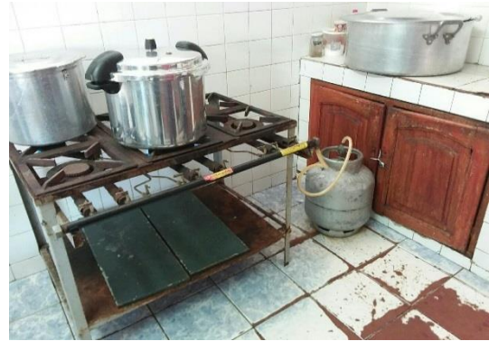
Botijão de gás em ambiente interno e inadequado e mobiliário danificado
