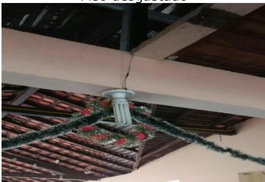
Fiações expostas e improvisadas
