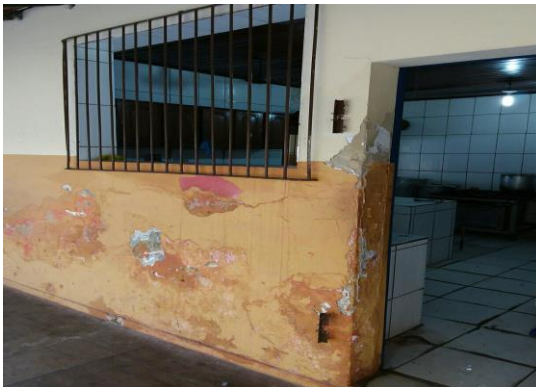
Revestimentos danificados, queda de reboco e infiltração
