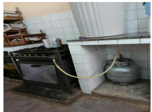
Botijão de gás em ambiente interno e inadequado
