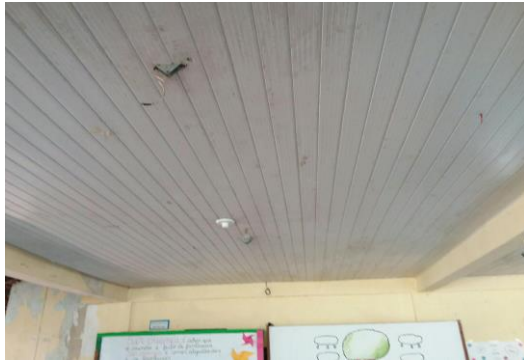
Fiações expostas e improvisadas
