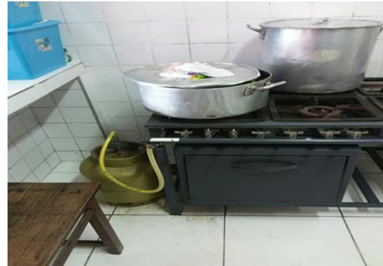
Botijão de gás em ambiente e local inadequado
