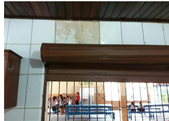
Revestimento danificado, queda de reboco e tela de proteção inexistente
