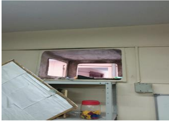
Caixa de ar-condicionado com vão aberto
