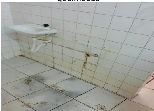
Impropriedades com torneiras e inexistência de lavatório
