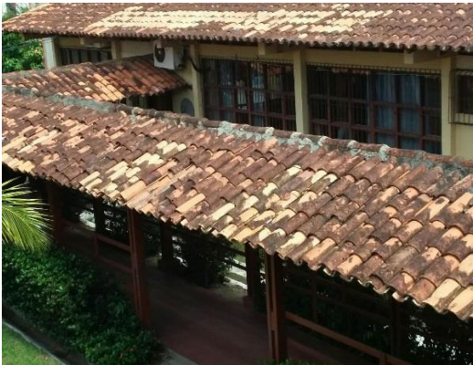
Cobertura danificada e goteiras
