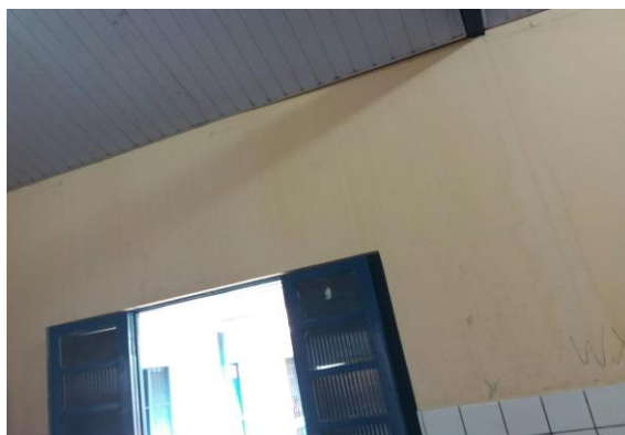
Infiltrações e pintura danificada
