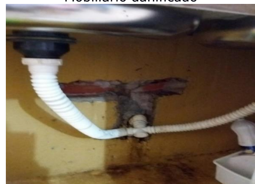
Revestimento danificado e vazamentos
