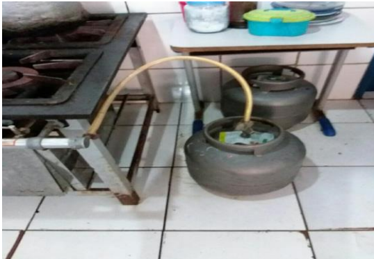
Botijões de gás em local inadequado
