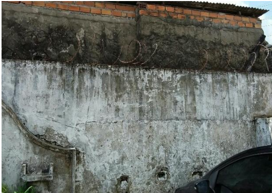
Muro e concertina danificados
