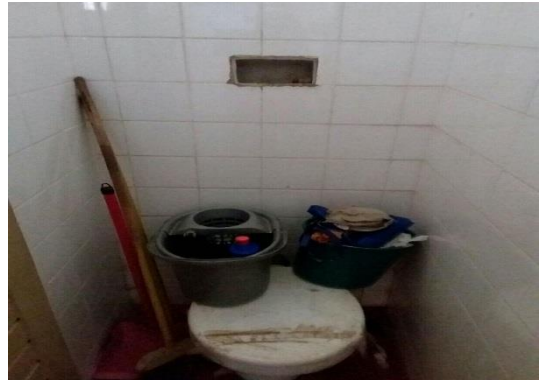
Impropriedades com vaso sanitário
