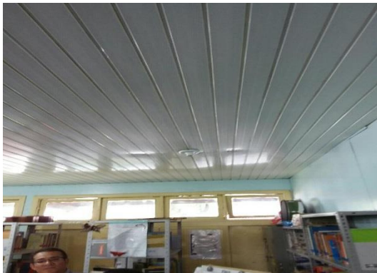
Inexistência de lâmpada
