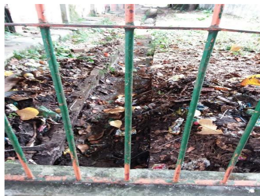
Necessidade de limpeza
