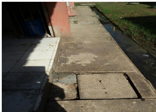
Impropriedades no sistema de drenagem
