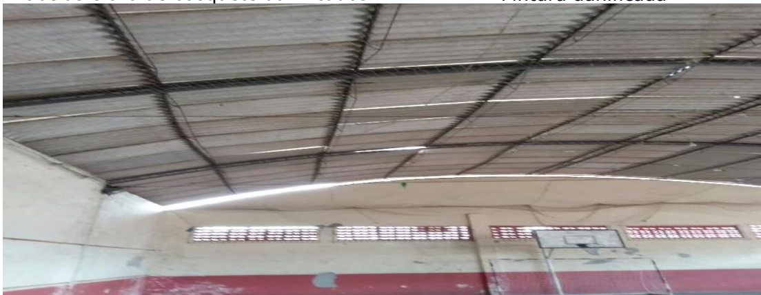
Telhado e tela de proteção danificados
