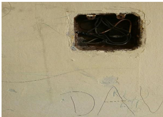
Fiações expostas e pintura danificada
