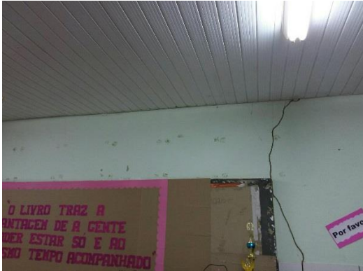
Fiação exposta e pintura danificada
