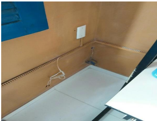
Fiações expostas e improvisadas
