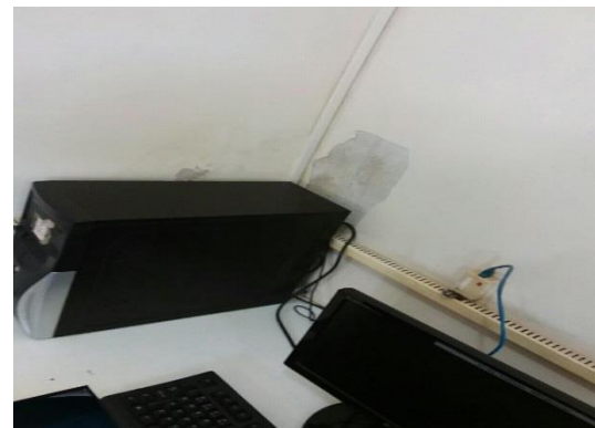
Equipamentos danificados e queda de reboco
