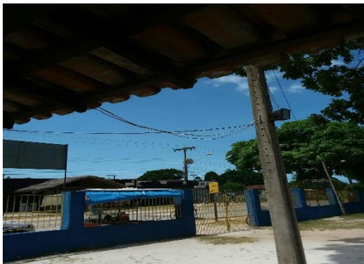
Fiações expostas e improvisadas
