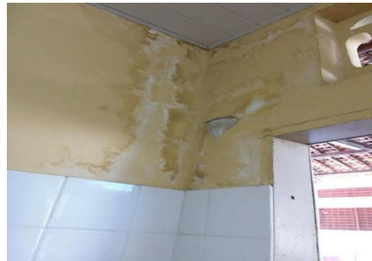
Infiltrações e Queda de reboco
