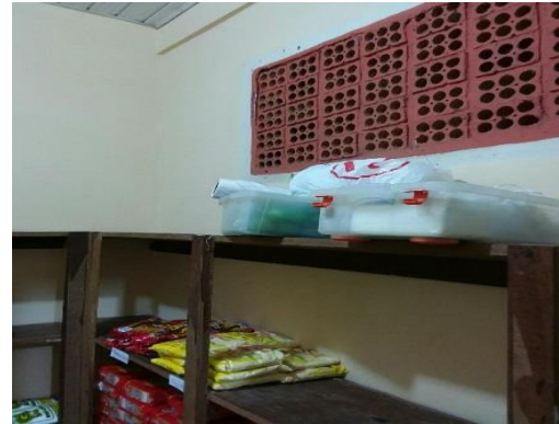
Inexistência de tela de proteção na abertura externa
