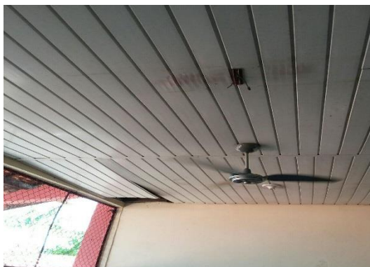
Forro danificado, fiação exposta e inexistência de lâmpada
