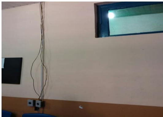
Fiações expostas e improvisadas
