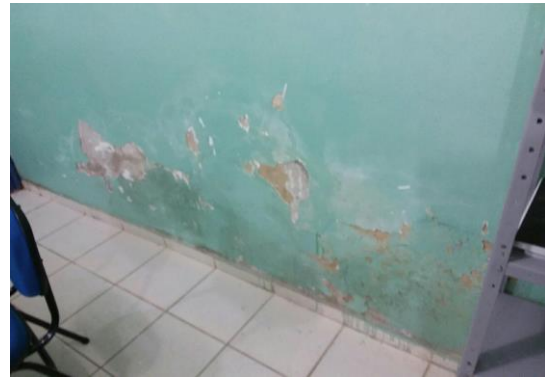
Infiltrações e pintura danificada
