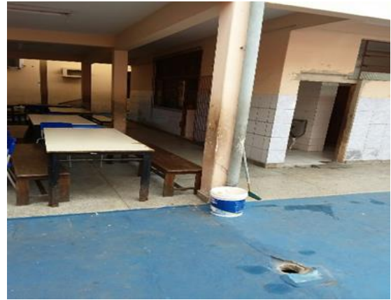
Fossa sem tampa e em comunicação direta com o refeitório
