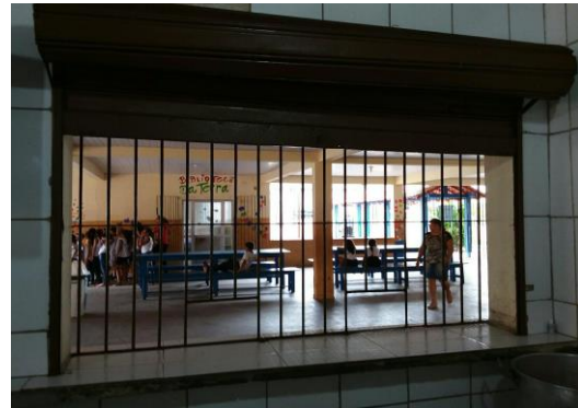
Iluminação insuficiente e inexistência de tela de proteção nas aberturas externas
