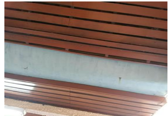
Calha com vazamentos
