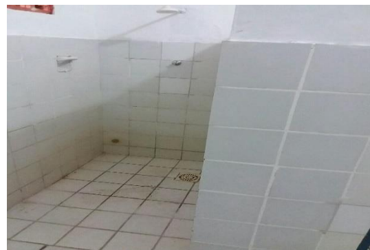
Impropriedades com a drenagem
