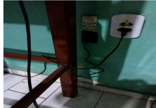
Fiações expostas / improvisadas
