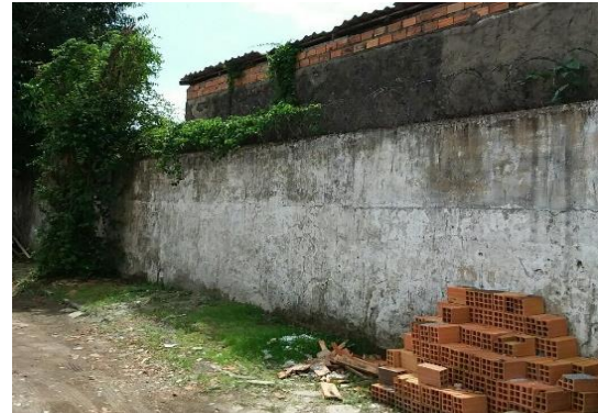
Necessidade de capinação e poda de árvore
