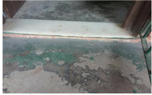
Restrição e limitação de acesso para PcD
