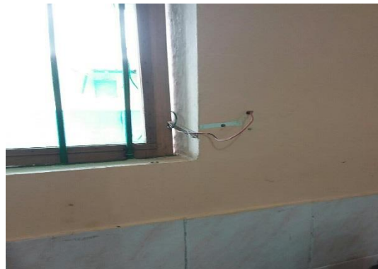
Fiações expostas e improvisadas
