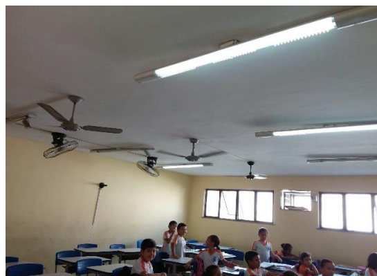
Lâmpadas queimadas e ventiladores improvisados
