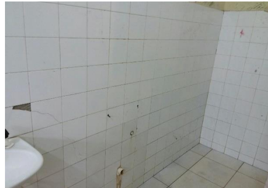
Inexistência de mictório, rachadura e impropriedades no revestimento
