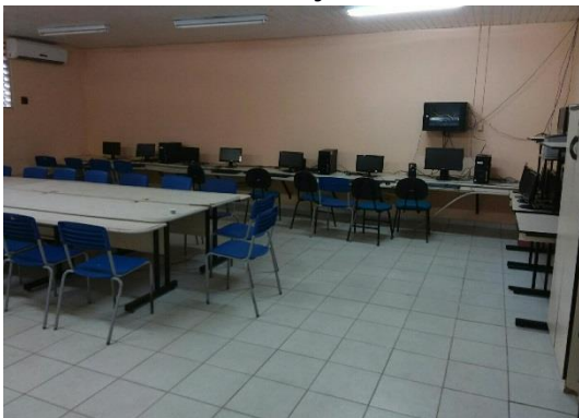
Lâmpadas queimadas, fiações expostas e improvisadas
