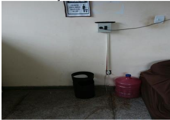
Fiações expostas e goteiras
