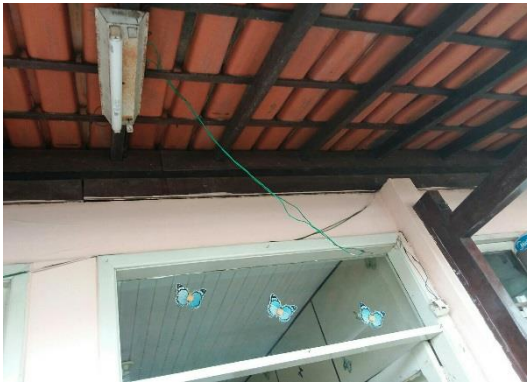
Lâmpada queimada e fiações expostas
