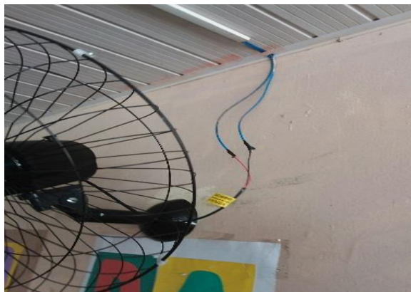
Fiações expostas e improvisadas
