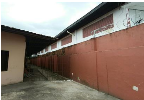
Concertina parcialmente inexistente
