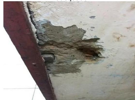
Queda de reboco e pintura danificada
