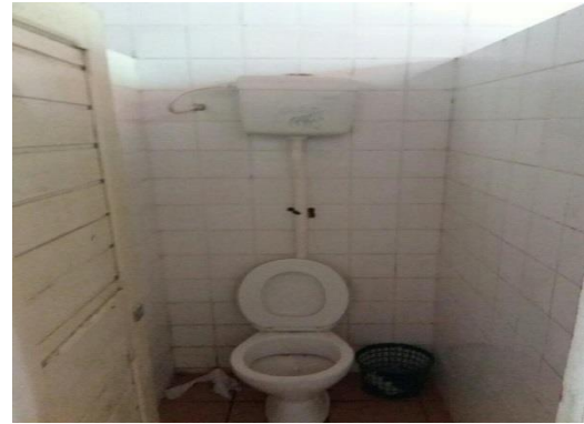
Impropriedades com o vaso sanitário
