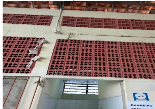
Fiações expostas e improvisadas
