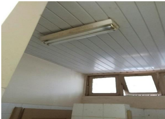
Ventilação insuficiente e lâmpadas queimadas
