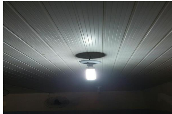
Iluminação insuficiente (pouca iluminação)
