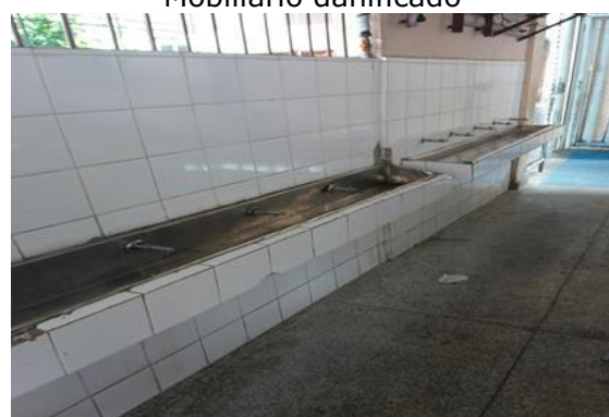
Bebedouro com defeito e revestimento danificado
