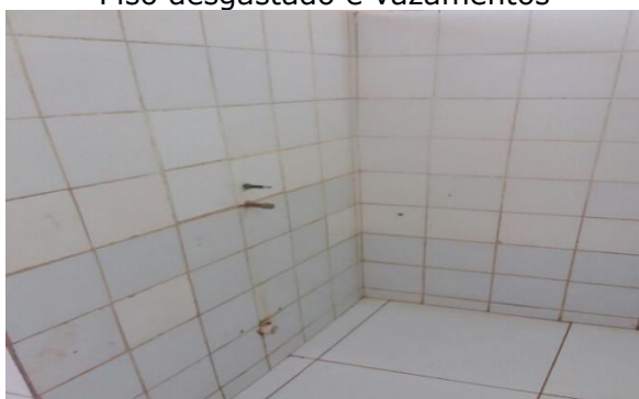
Inexistência de registro de chuveiro
