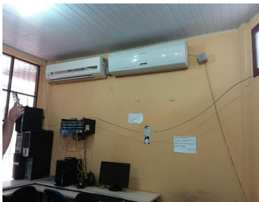
Fiações expostas e improvisadas
