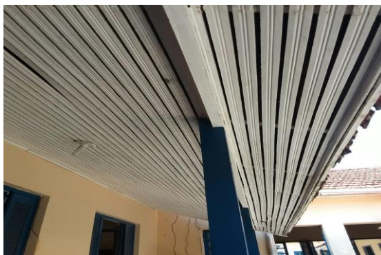
Lâmpadas queimadas e forro danificado
