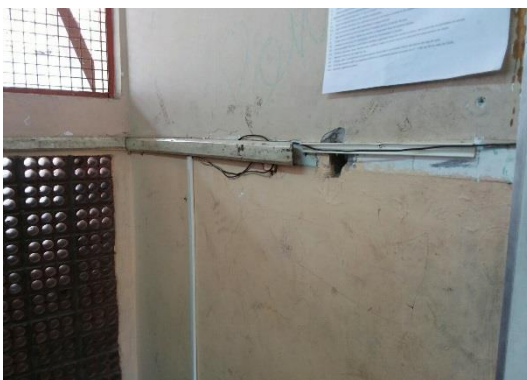
Fiações expostas e improvisadas
