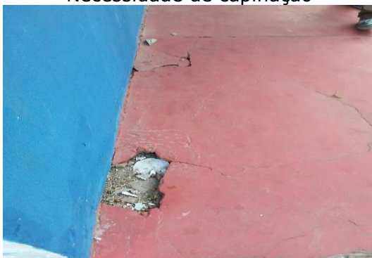
Piso danificado e desgastado
