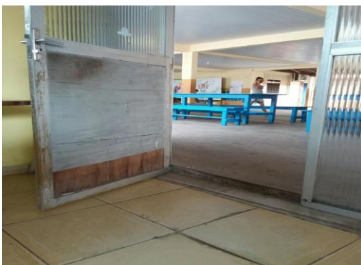
Restrição/limitação de acesso para PPD
