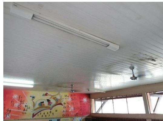
Lâmpada queimada e forro danificado
