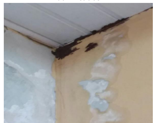
Infiltrações, pintura e forro danificados
