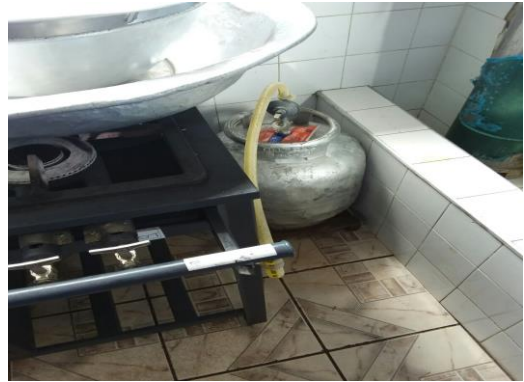
Botijão de gás no ambiente interno/ inadequado
