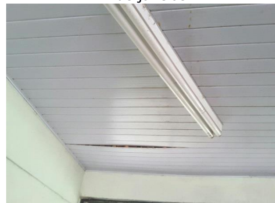
Forro danificado e lampadas queimadas
