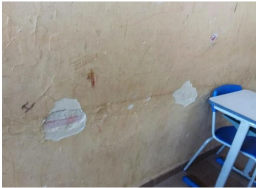
Revestimentos e pintura danificados e queda de reboco
