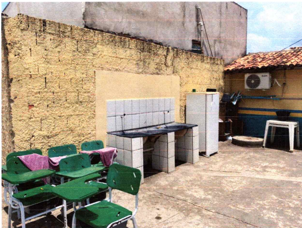
Figura 12 – Imagem da lavanderia.
